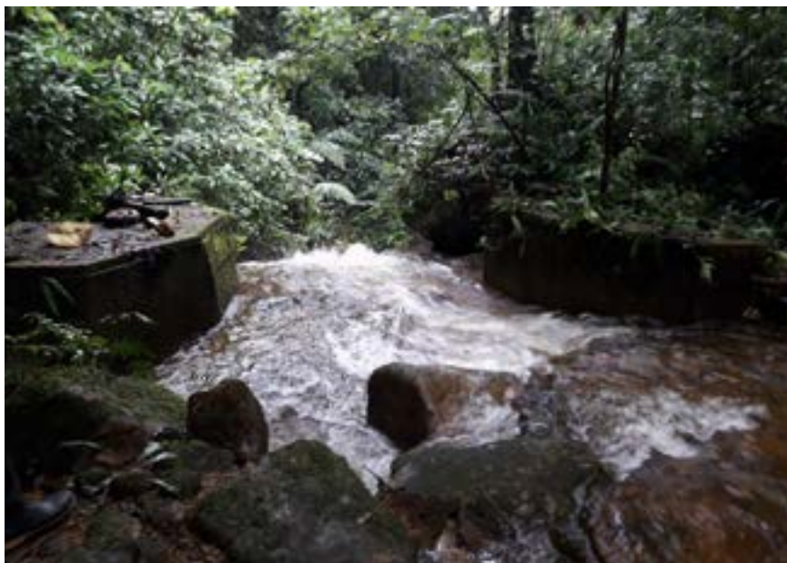
Imagen 57. Bocatoma de fondo del acueducto Buena Vista.
