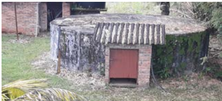
Imagen 62. Tanque de almacenamiento cilíndrico.
