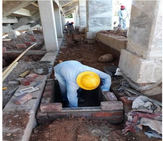
Fotografía N°8. Caja de inspección.
