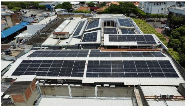
Figura 28. Sistema solar fotovoltaico por monitorear.
