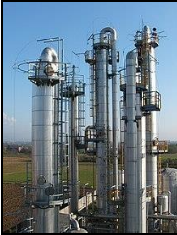
Figura 1. Columna de destilación.
