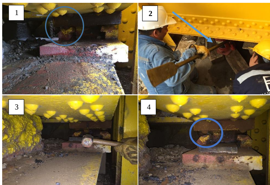
Imagen 17. 1. Apoyo viga de rigidez, contacto de pernos con elemento guía; 2. Colocación de gato para elevar viga de rigidez; 3. Colocación de lámina de relleno bajo la parte fija de la viga de rigidez; 4. Se observa separación entre la cabeza de los remaches del elemento de la viga de rigidez y la sección de apoyo.
