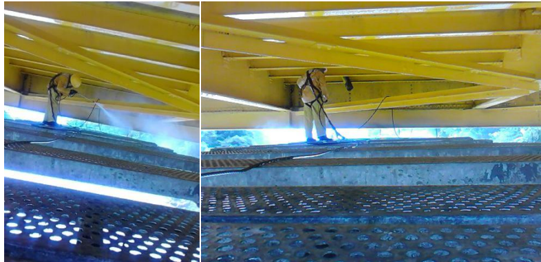
Imagen 18. Plataforma para lavado con chorro de agua parte inferior del tablero. Fuente: Instituto Nacional de Vías, Consorcio Puentes La Cabuya 2015
