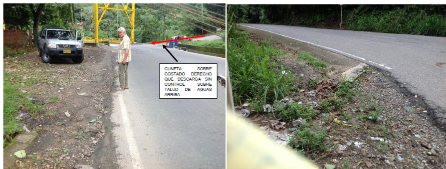
Imagen 33. Cuneta que descarga sobre talud aguas arriba margen izquierdo. Fuente: Consorcio IPV. Contrato 0922-2015. Diagnóstico y obras de emergencia para el puente La Cabuya sobre el Río Cravo Sur, como resultado de los fenómenos de socavación y movimientos de masa observados. 2015.
