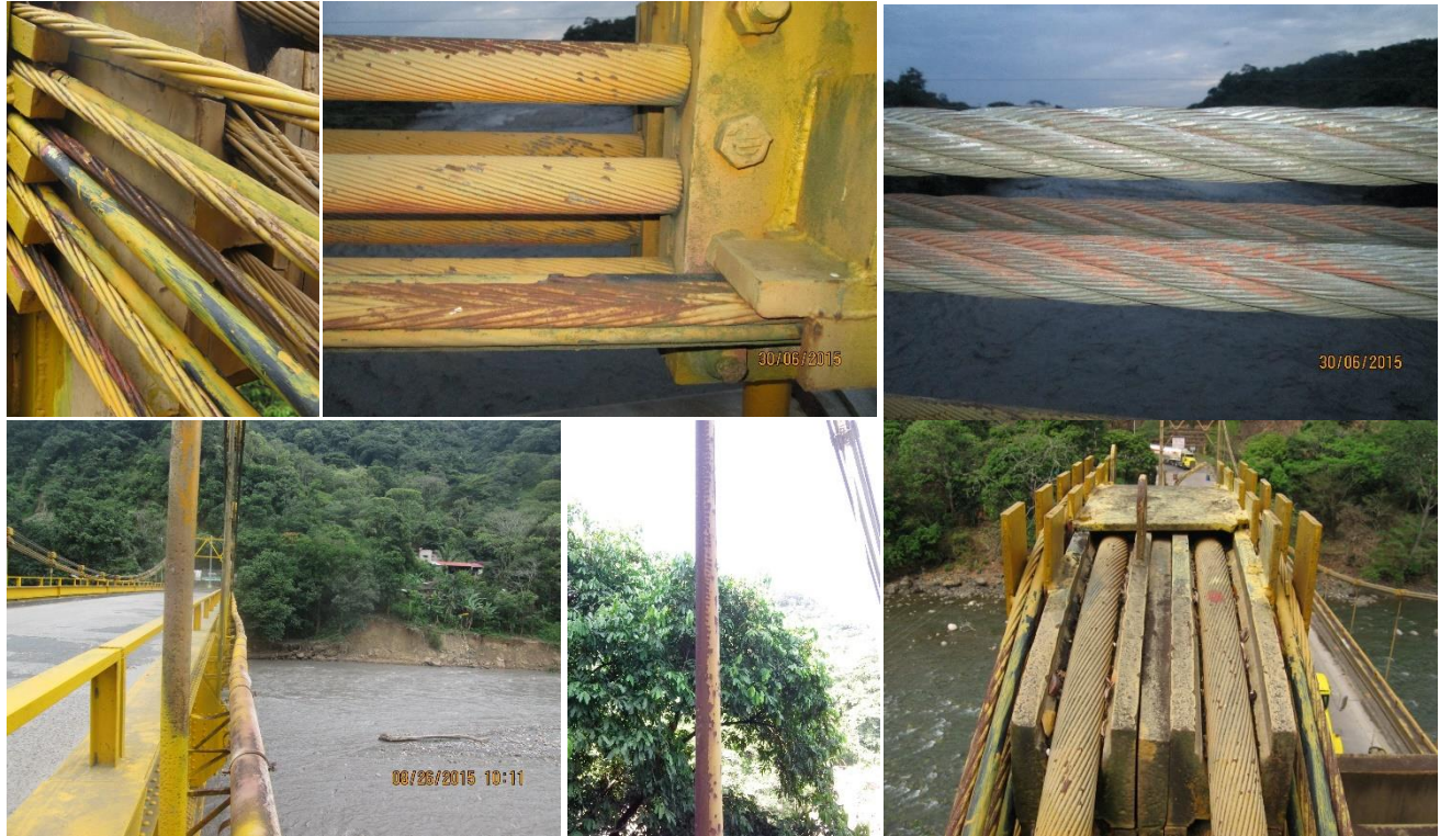
Imagen 91. Oxidación y corrosión en cables, torones y pendolones. Registro de zona Galápagos, abrazadera en zona intermedia (entre torres), pendolones. Fuente: Contrato 0922-2015.
