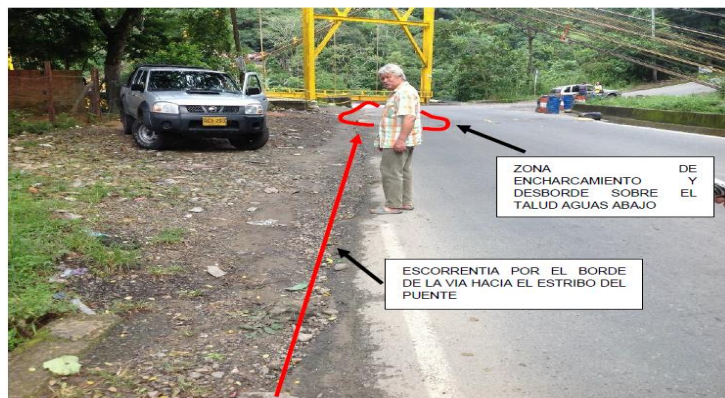
Imagen 34. Escorrentía borde vía y encharcamiento acceso margen izquierdo. Fuente: Consorcio IPV. Contrato 0922-2015. Diagnóstico y obras de emergencia para el puente La Cabuya sobre el Río Cravo Sur, como resultado de los fenómenos de socavación y movimientos de masa observados. 2015.
