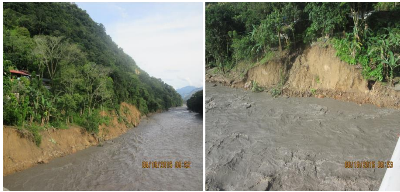
Imagen 98. Socavación Zona 1. Margen derecho río Cravo Sur.
