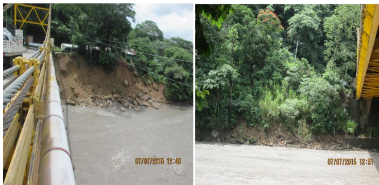
Imagen 99. Socavación zona 22. Margen izquierdo río Cravo Sur. Fuente: Contrato 0922-2015 Invías.
