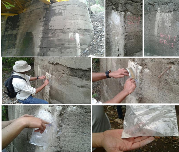
Imagen 95. Eflorescencias en el estribo margen derecho. Fuente: Propia.
