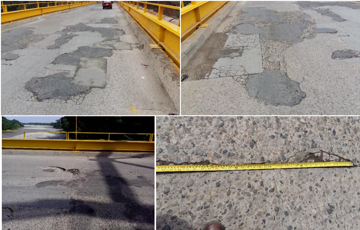
Imagen 93. Tablero con presencia de parches, fisuras, pérdida y pulimento de agregado. Fuente: Propia.
