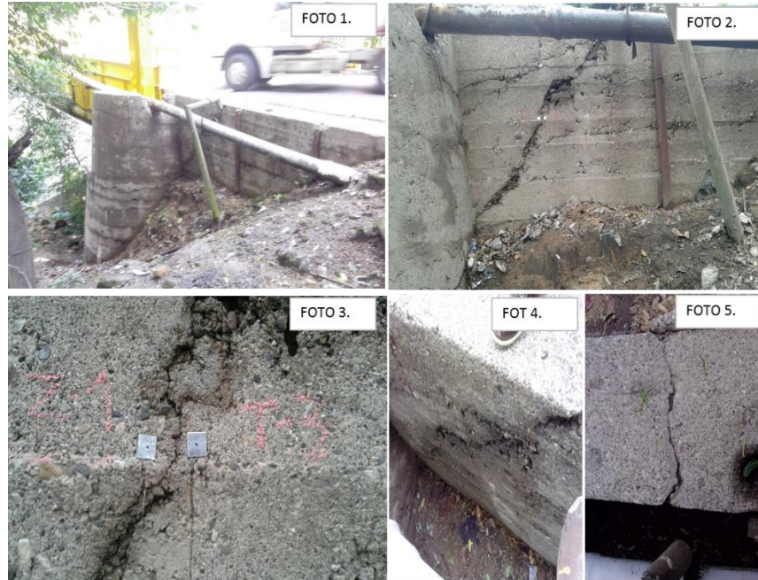
Imagen 97. Junta fría y hormigueros en muro de contención acceso puente margen derecho. Fuente: Propia.
