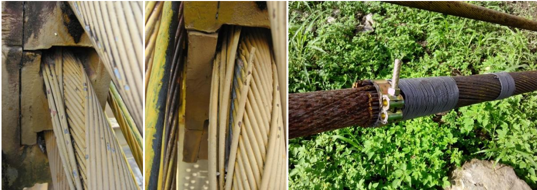
Imagen 96. Rotura de alambres en cables de 2". Fuente: Contrato 0922-2015 Inviás.
