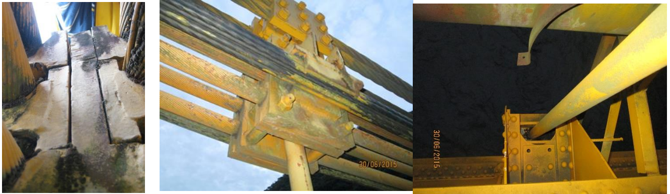
Imagen 89. Acumulación de suciedad en zona de galápagos, abrazaderas zona intermedia (entre torres) y conexión pendolones a viga de rigidez en zona intermedia.
