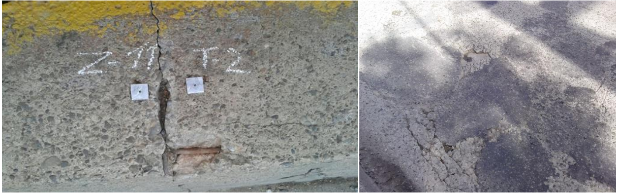
Imagen 92. Grieta alrededor de guardarueda, acero de refuerzo fallado; Superficie de rodadura con fisuramiento tipo piel de cocodrilo y parcheo. Fuente: Propia.
