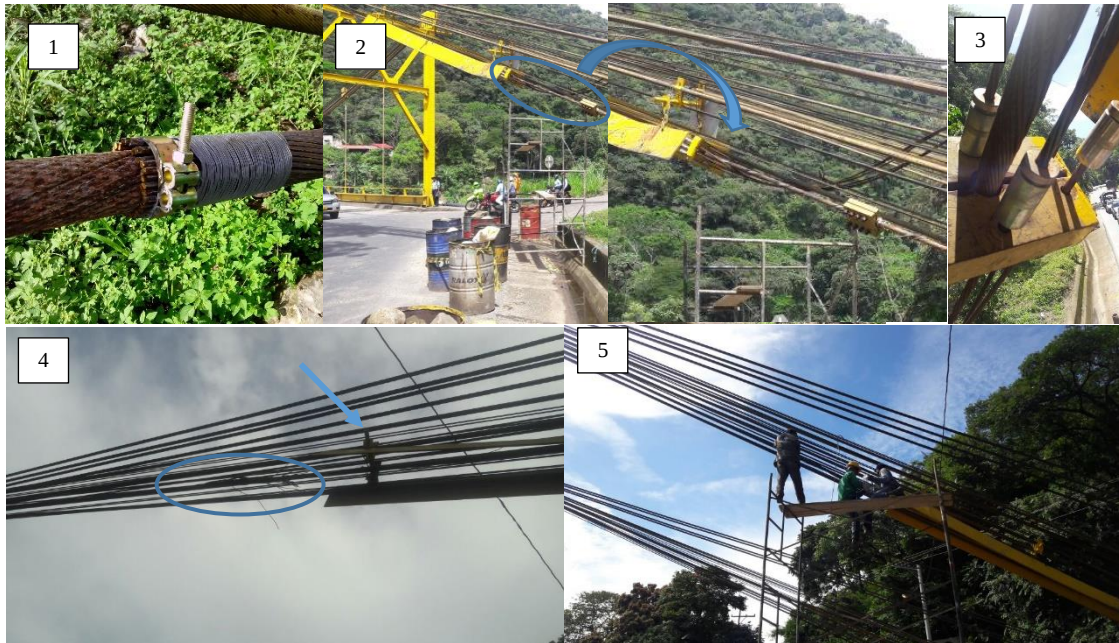
Imagen 21. 1. Corte de los alambres deteriorados y amarre con alambre y abrazaderas; 2. Se observa zona cables deteriorados y reforzados con torones de 5/8" baja relación grado 270; 3. Detalle abrazaderas metálicas especiales y cuñas; 4-5. Vista zona deteriorada y personal realizando reparación. Fuente: Instituto Nacional de Vías, Consorcio Puentes La Cabuya 2015
