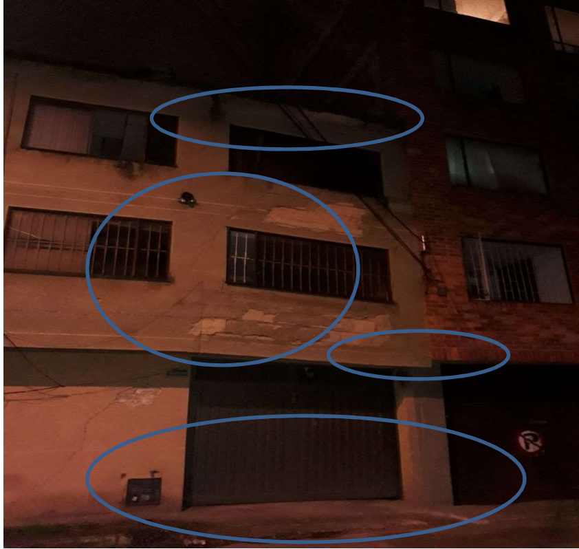
Imagen 5 Tipo de lesiones en fachada. Fuente propia.
