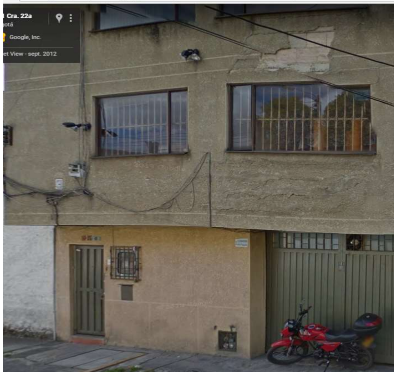
Imagen 3 Lesión de la vivienda. Fuente: Google Maps.
