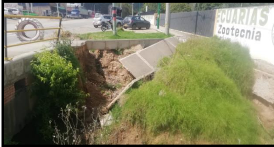
Figura 14. Andén desestabilizado sector La María.
