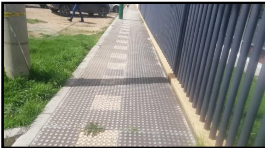
Figura 15. Baldosas podo-táctiles con mal direccionamiento.
