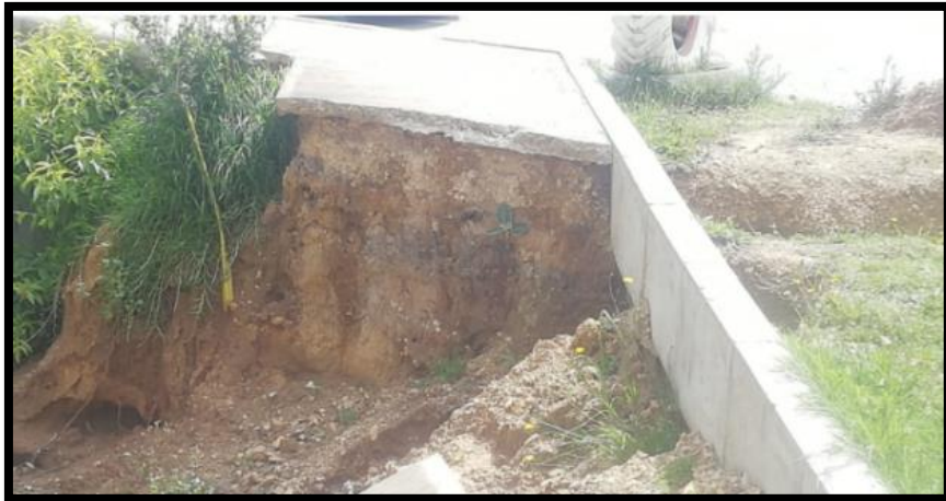
Figura 13. Andén desestabilizado sector La María.
