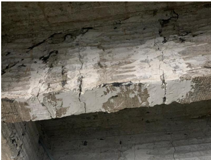
Ilustración 2 Vigueta con grietas severas y restos de una reparación sin efecto
