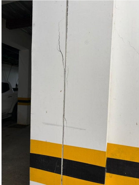
Ilustración 4 Grietas en la junta de construcción del edificio con el parqueadero
