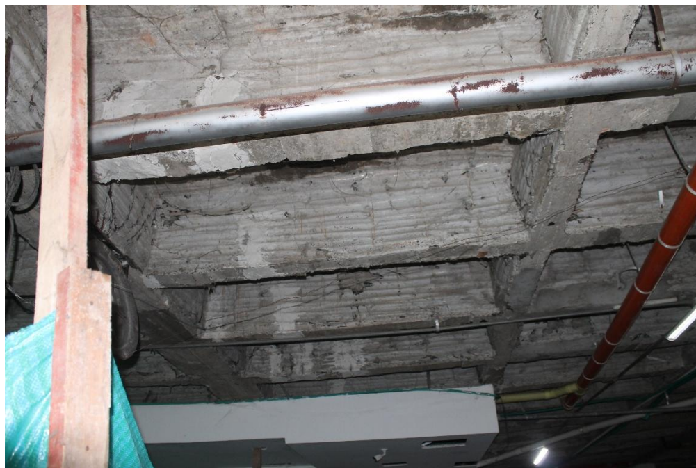
Ilustración 5 Viguetas con rastros de mortero de reparacion cerca a la viga principal.
