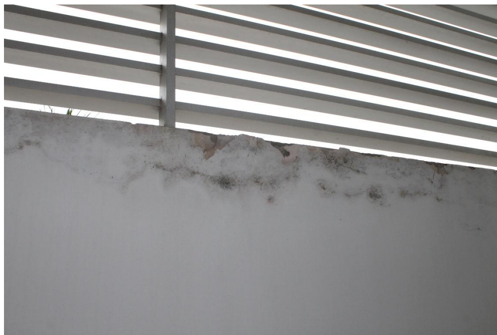
Ilustración 6 Daños por humedad presente en los muros del segundo piso del parqueadero
