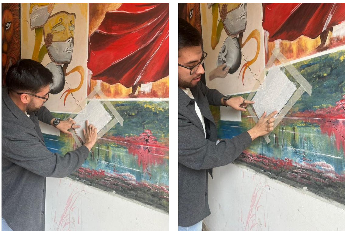
Figura 14. Instalación de testigos para control de fisuras fuente propia piso uno, entrada principal.
