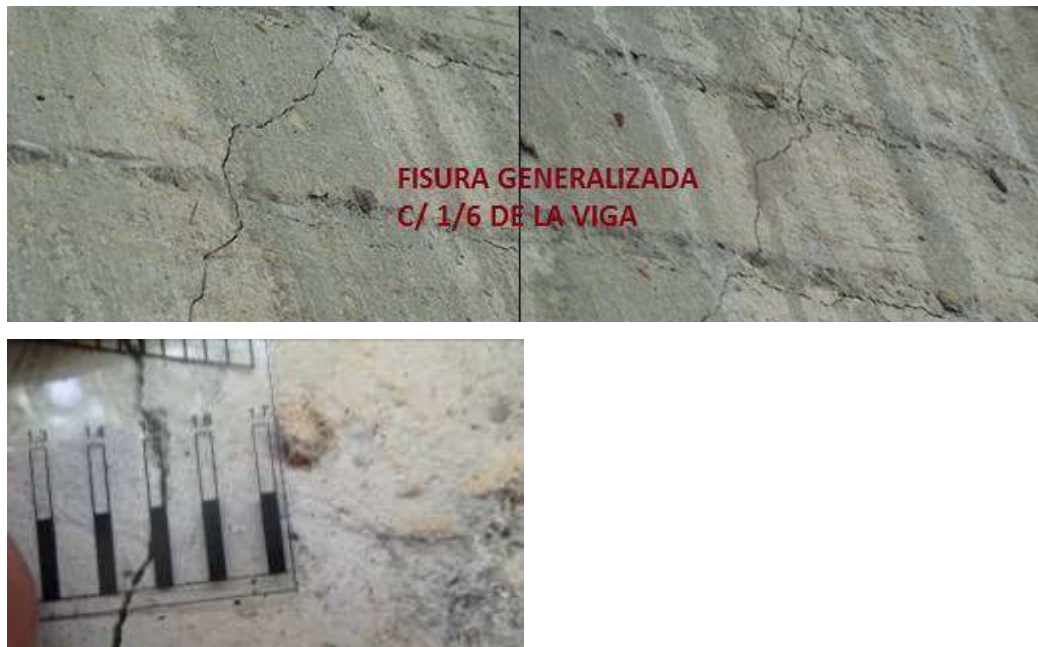
Figura 38. Fisuras en las vigas
