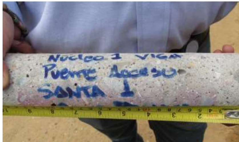
Figura 49. Obtención del frente de carbonatación en núcleos extraídos de las vigas de la superestructura
