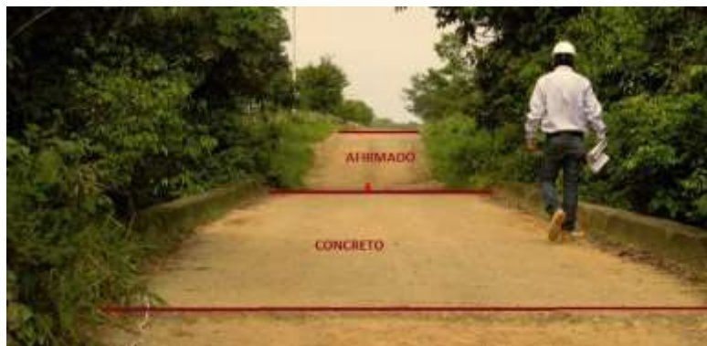
Figura 24. Superficie en afirmado 10 m antes, sobre el puente concreto y 10 m después del puente
