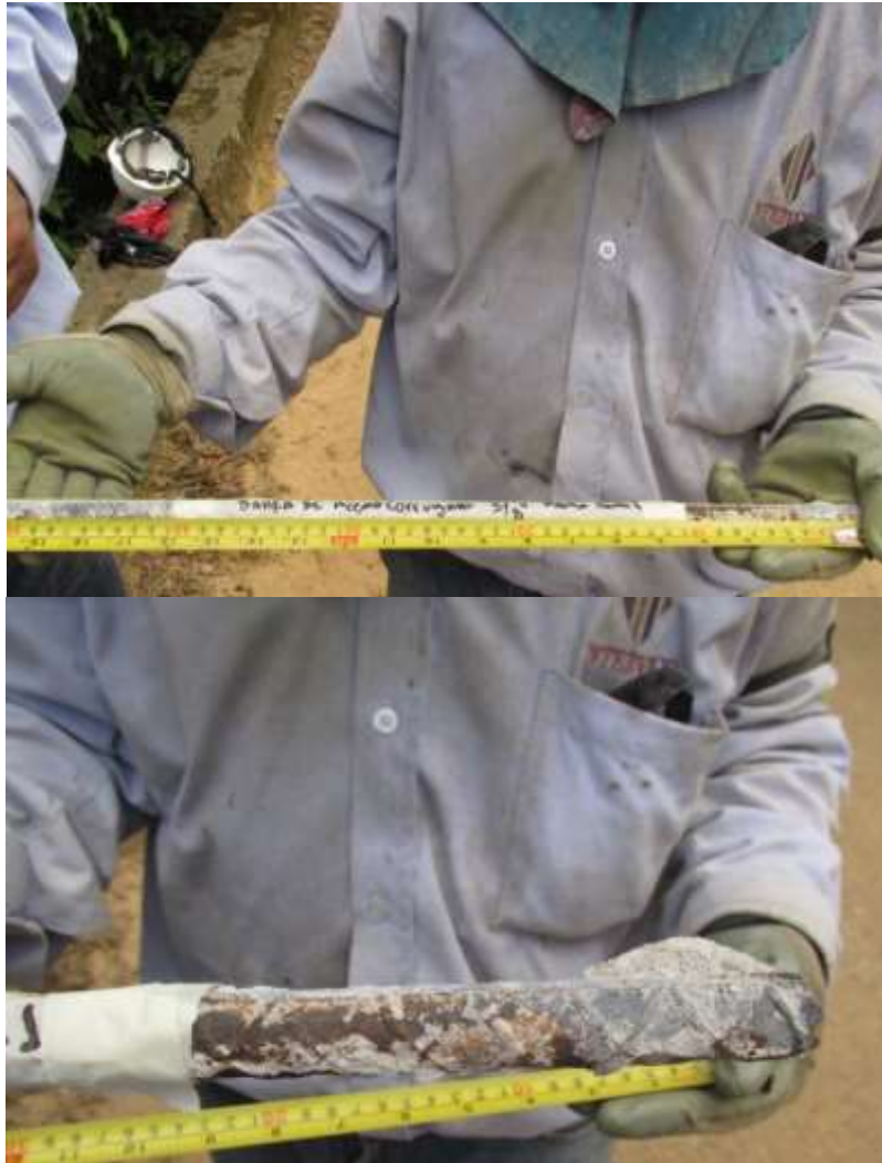
Figura 61. Evidencia de la barra de acero de 5/8" extraída del tablero
