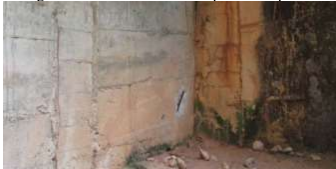
Figura 8. Detalle de apoyo de vigas con estribo donde no existe neopreno
