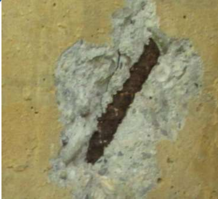
Figura 47. Corrosión puntual de la armadura de la viga de la superestructura
