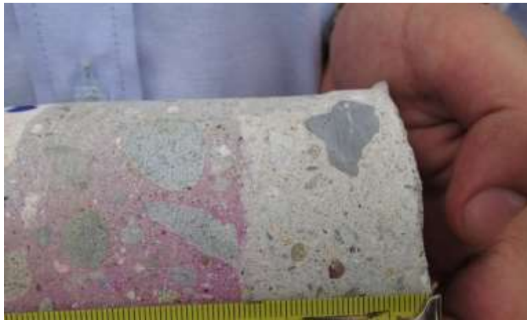
Figura 73. Se evidencia que el frente de carbonatación en el concreto es errático el cual avanzo entre 3 a 4 cm.
