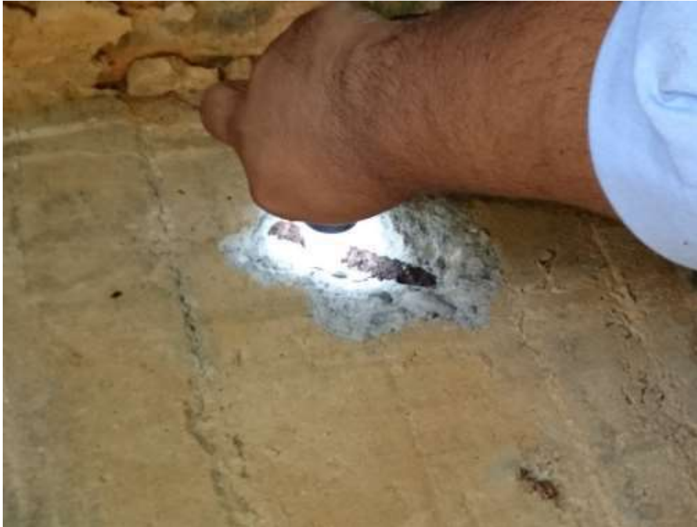
Figura 45. Detalle de corrosión del acero donde se aprecia el desprendimiento del concreto por el efecto de expansión.
