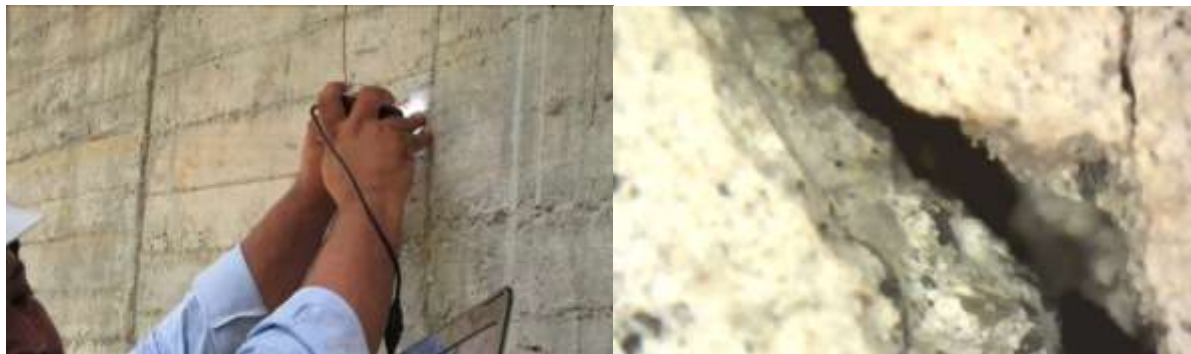
Figura 71. Fisuras en las vigas levantadas con microscopio de barrido
