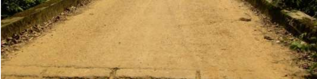
Figura 29. Inexistencia de Juntas del puente según codificación de INVIAS
