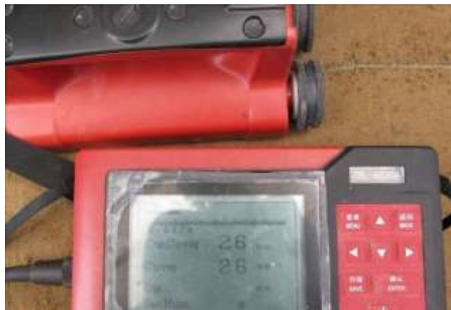
Figura 41. Verificación del recubrimiento y de la existencia de refuerzo con escáner de última generación sobre la losa superior, se aprecia un recubrimiento máximo de 26 mm.
