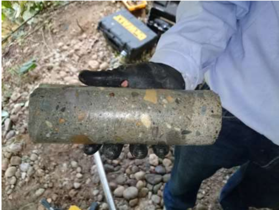
Figura 62. Detalle del concreto de los núcleos extraídos donde se observa tamaños finos del agregado
