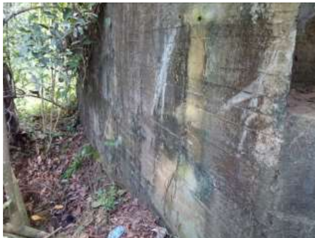
Figura 39. No se evidencia existencia de fisuración en estribos y/o aletas del puente
