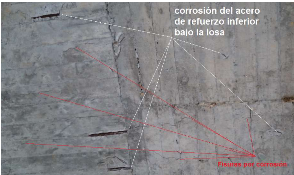
Figura 48. Corrosión puntual de la armadura inferior de la losa de la superestructura
