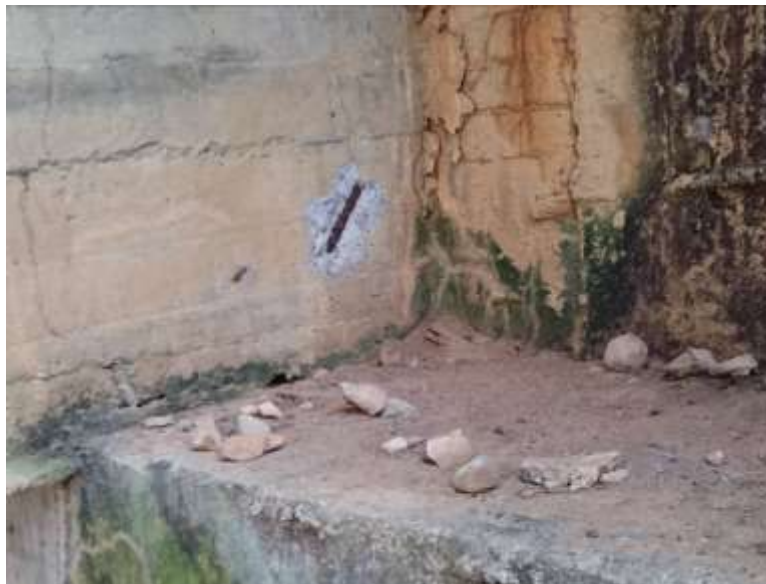
Figura 46. Acero de refuerzo con corrosión
