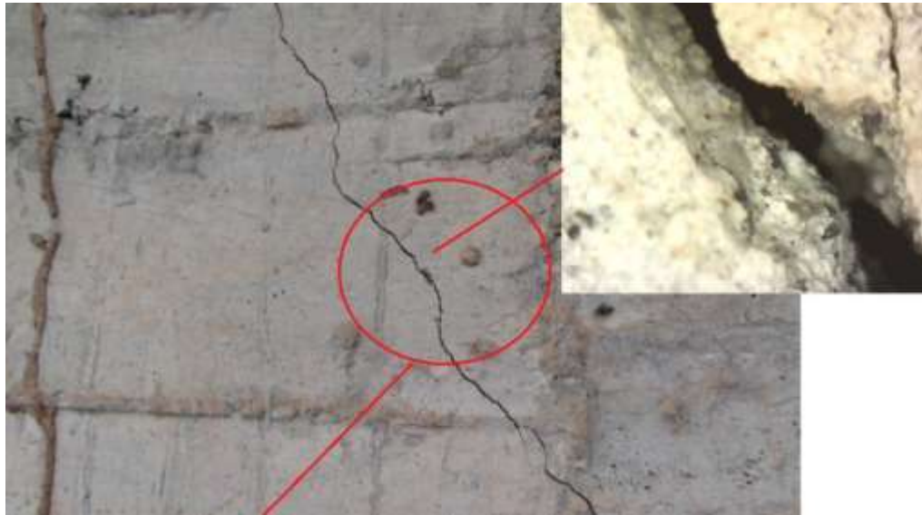
Figura 72. Detalle de fisuras en las vigas del puente
