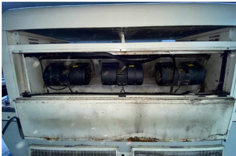
Fig. 27. Motores de Forzadores de Aire Chiller CC-40
