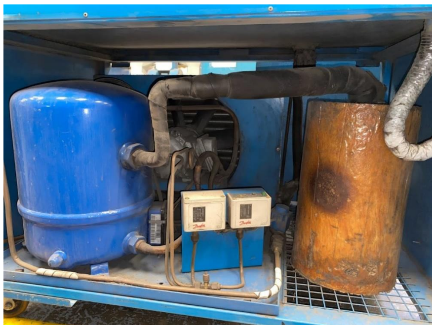
Fig. 31. Compresor y Condensador de Chiller CC-1
