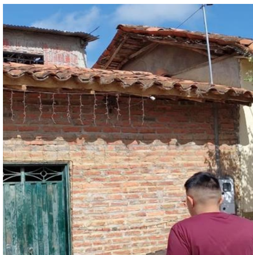
Figura 38. Visita realizada por afectaciones en el techo.
