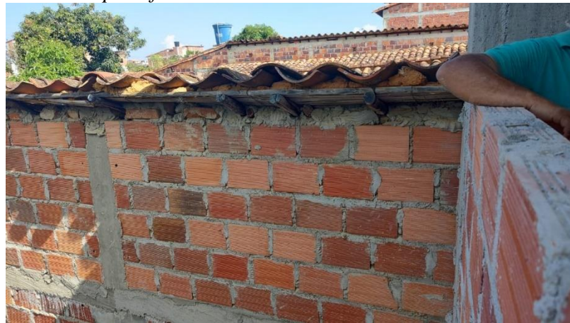
Figura 40. Visita realizada por afectaciones en el techo
