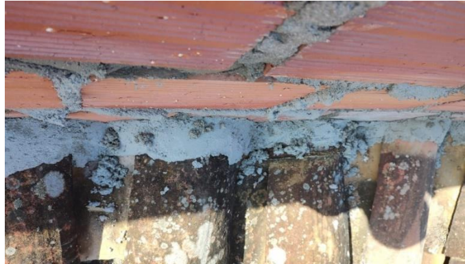
Figura 39. Visita realizada por afectaciones en el techo
