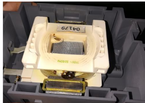
Figura 7. Bobina de contractor dañada.
