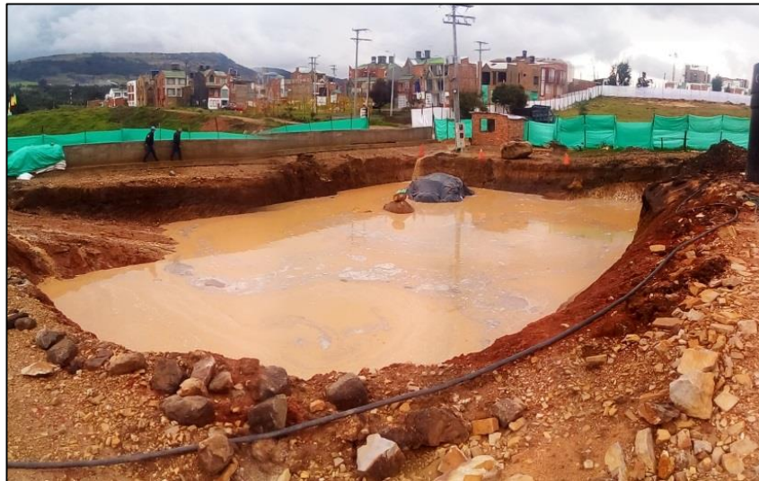
Figura 22 Empozamiento de agua por precipitaciones – Torre 1.
