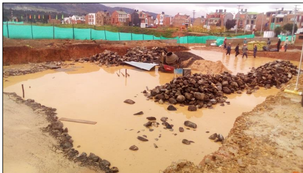
Figura 21 Empozamiento de agua en la Torre 2 durante construcción de concreto ciclópeo.
