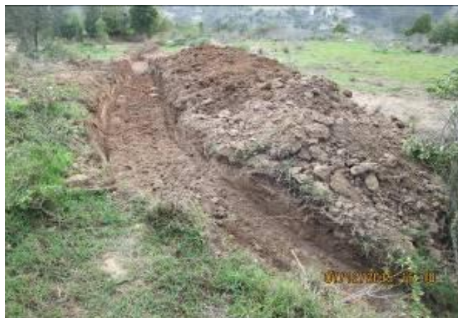
Figura 5. Zanja para manejo de aguas lluvias en el acopio
