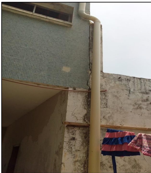
Fotografía 32. Deterioro y fisuración en elementos no estructurales.
