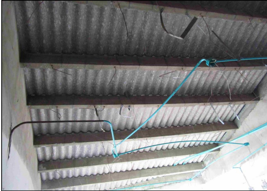
Fotografía 17. Deterioro de los elementos eléctricos debido a fallas en los mecanismos de soporte. Fuente Propia
