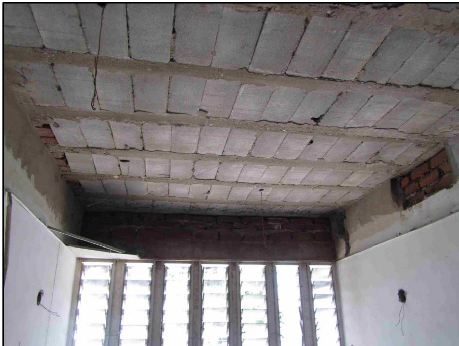
Fotografía 31. Fisuras en paredes y elementos no estructurales. Fuente Propia
