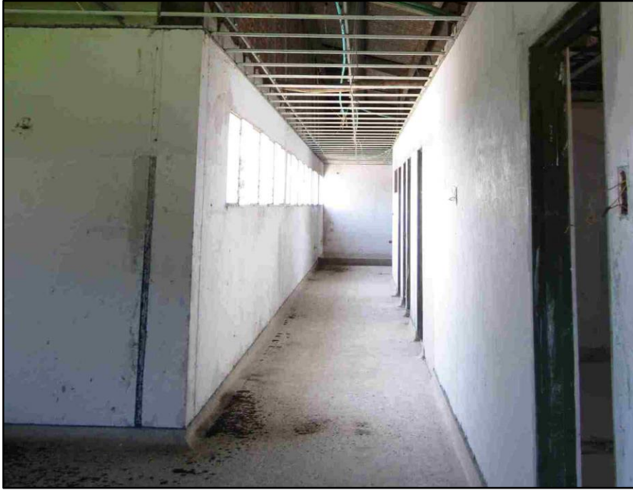
Fotografía 19. Fisuras en muros debido a esfuerzos mecánicos. Fuente Propia
