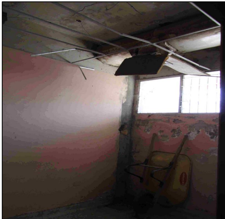
Fotografía 14. Deterioro del cielo raso debido a falla en los elementos de soporte. Fuente Propia
