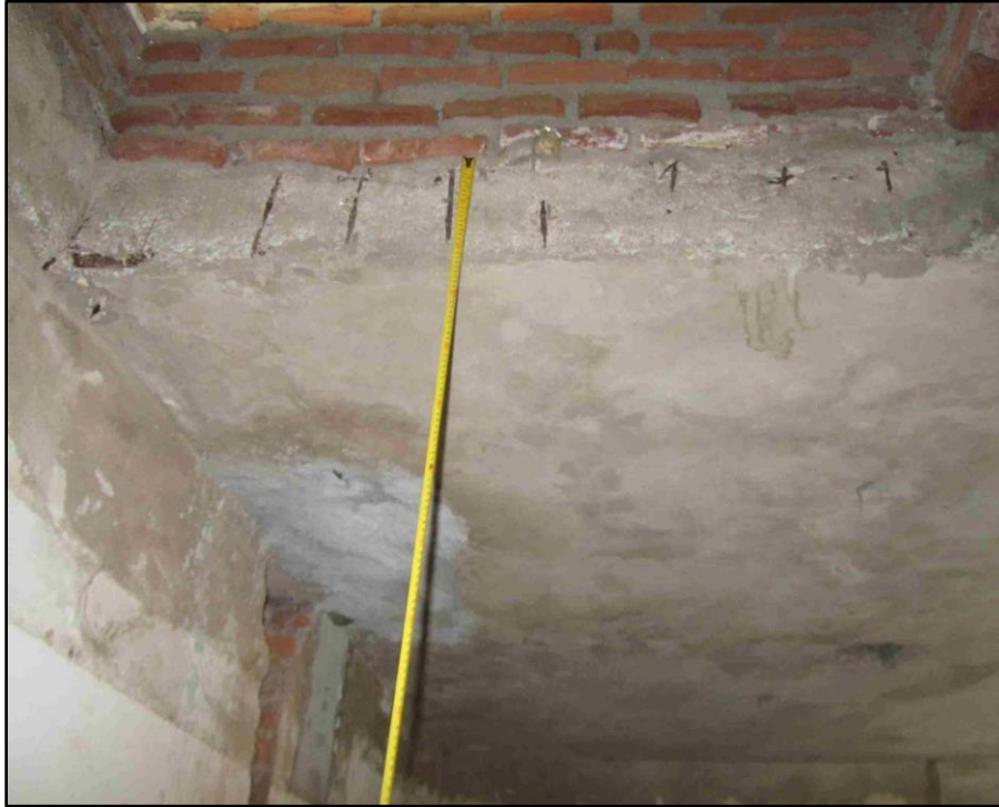
Fotografía 29. Pérdida del recubrimiento de los aceros de la losa. Fuente Propia
