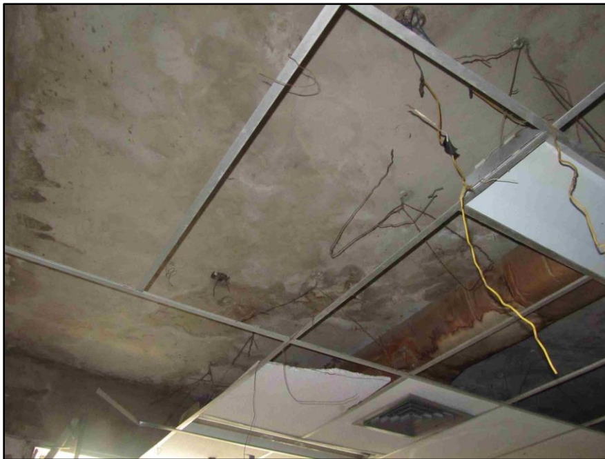
Fotografía 16. Manchas e infiltración de agua en la losa. Fuente Propia
