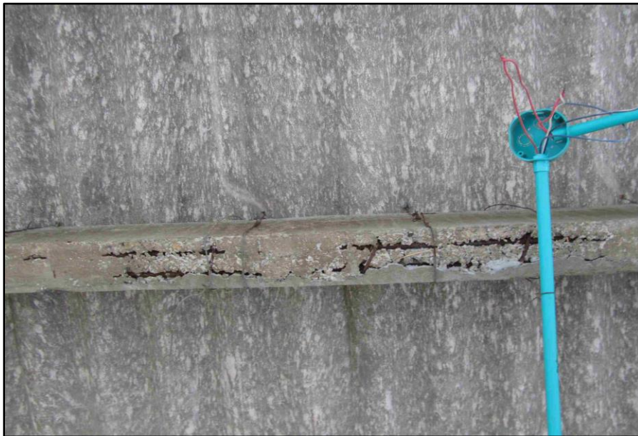
Fotografía 30. Pérdida del recubrimiento de los aceros de las viguetas de la cubierta. Fuente Propia
