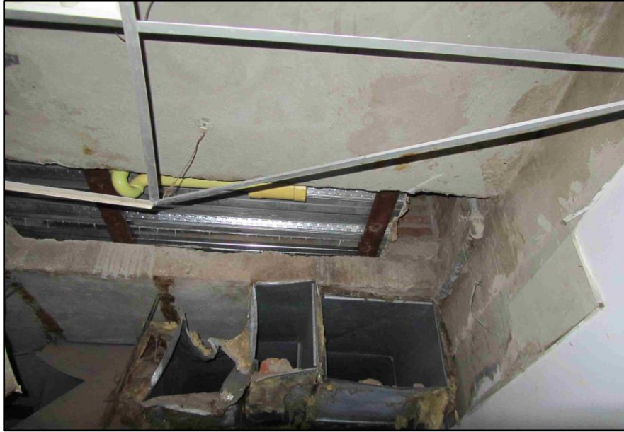
Fotografía 27. Corrosión de los elementos de soporte o vigas de la losa en Steel Deck. Fuente Propia
