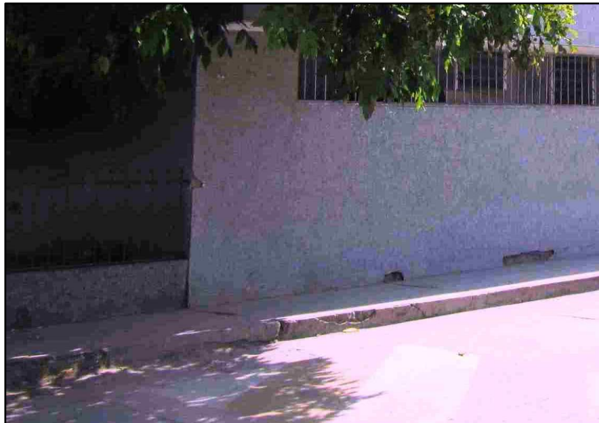
Fotografía 24. Deterioro de los andenes debido al agua y factores mecánicos. Fuente Propia
