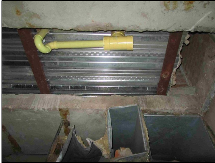
Fotografía 2. Losa en Metaldeck corroída. Fuente Propia
