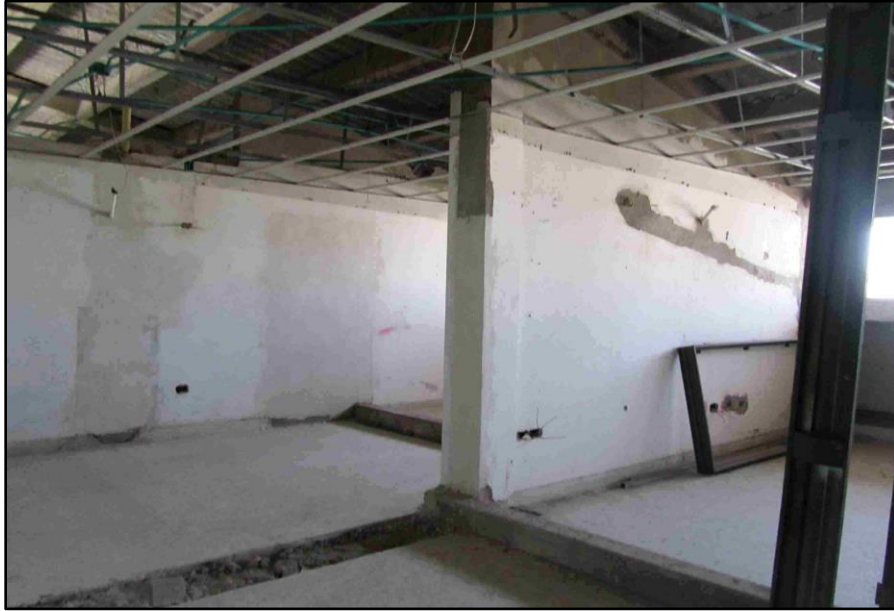
Fotografía 21. Fisuras en los muros debido a esfuerzos y movimientos mecánicos. Fuente Propia
