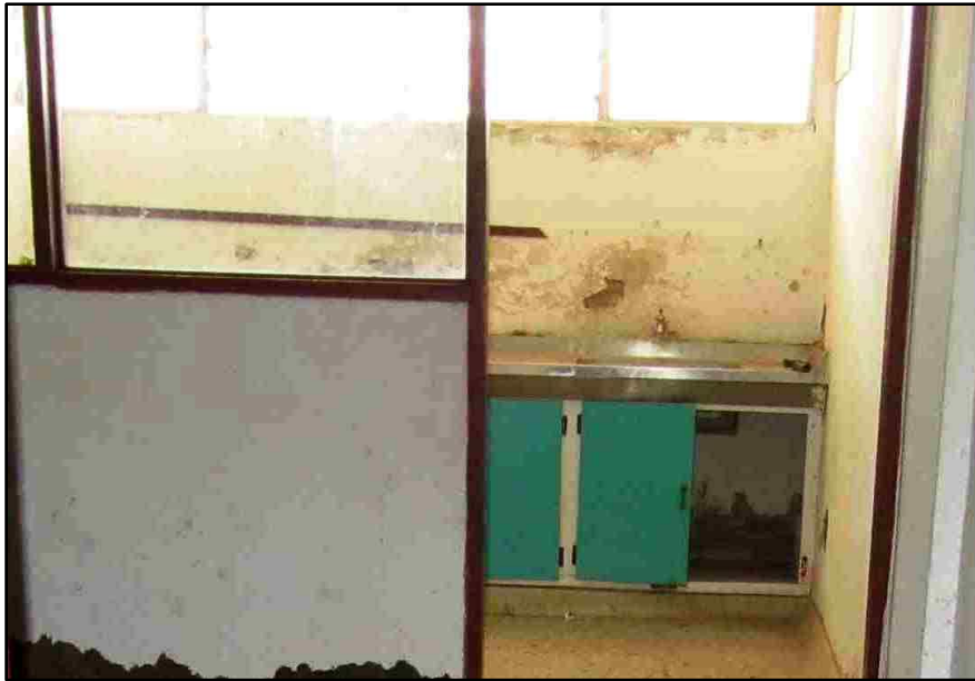
Fotografía 15. Deterioro del revoque por acción del agua. Fuente Propia
