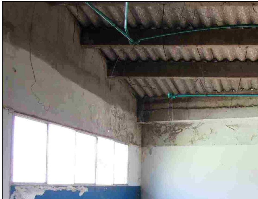
Fotografía 18. Deterioro de las paredes e infiltración de agua proveniente de las tuberías. Fuente Propia
