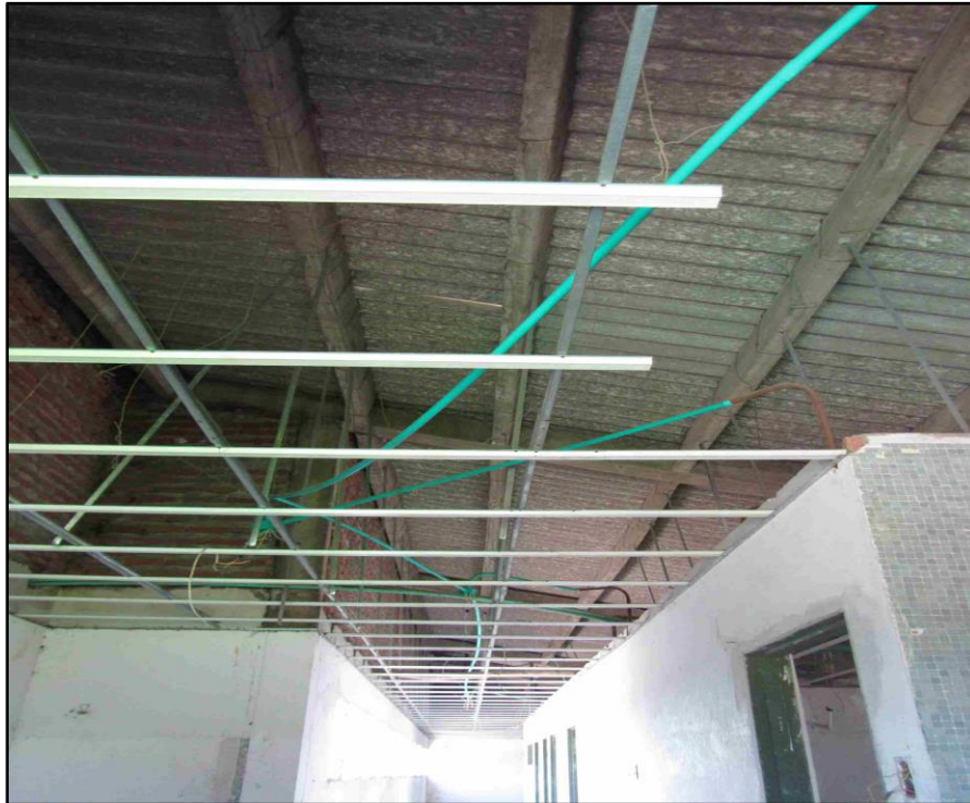
Fotografía 20. Deterioro de los elementos de soporte de la cubierta debido a agentes mecánicos y físicos. Fuente Propia
