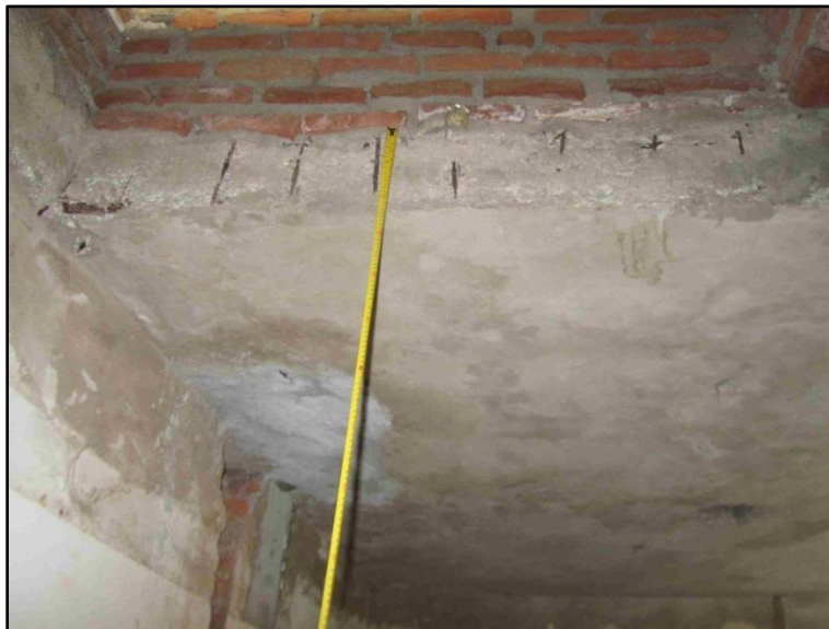
Fotografía 3. Losa maciza con refuerzo expuesto. Fuente Propia
