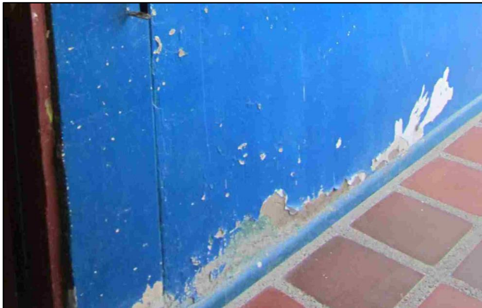
Fotografía 28. Deterioro de la fachada perdida del revoque por acción del agua. Fuente Propia
