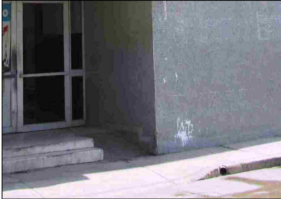
Fotografía 25. Eflorescencia e infiltración de agua. Fuente Propia
