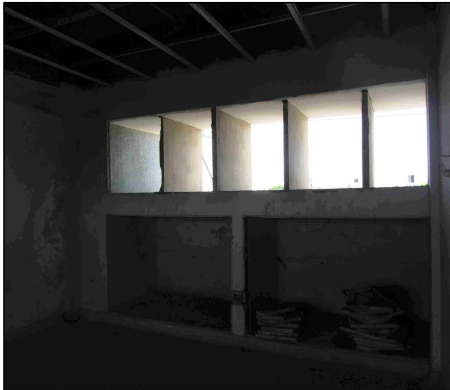
Fotografía 22. Deterioro de elementos de la fachada debido a acción del agua e intemperismo. Fuente Propia
