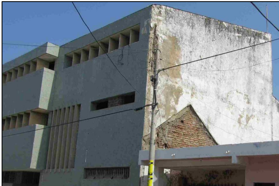
Fotografía 26. Deterioro de elementos de la fachada debido a acción del agua e intemperismo. Fuente Propia
