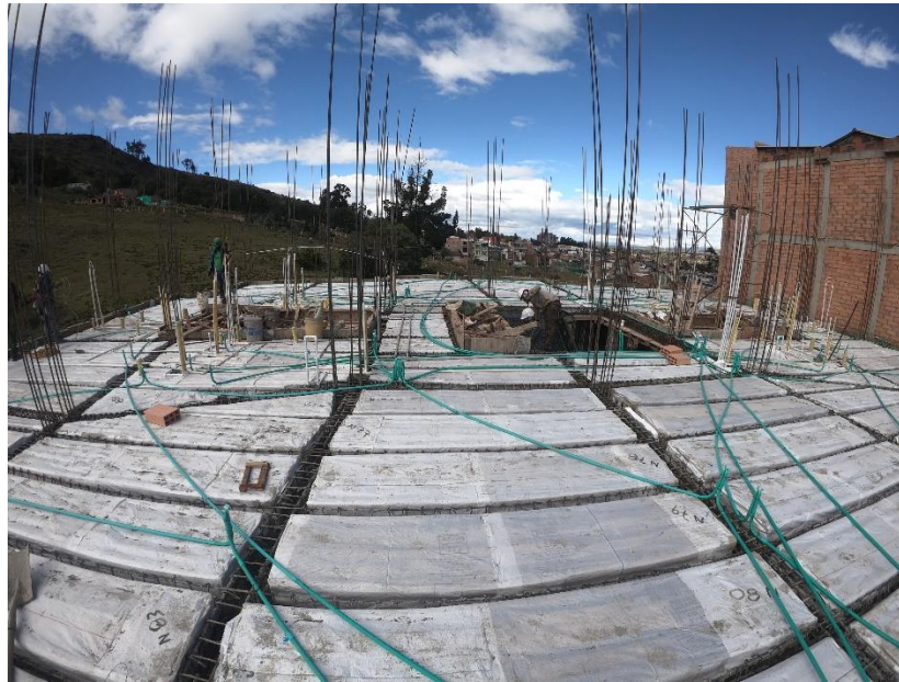
Imagen 21: Distribución de tubería eléctrica en placa de entrepiso
