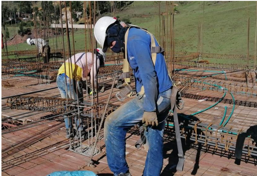
Imagen 47: Uso de arnés para trabajos en borde de placa
