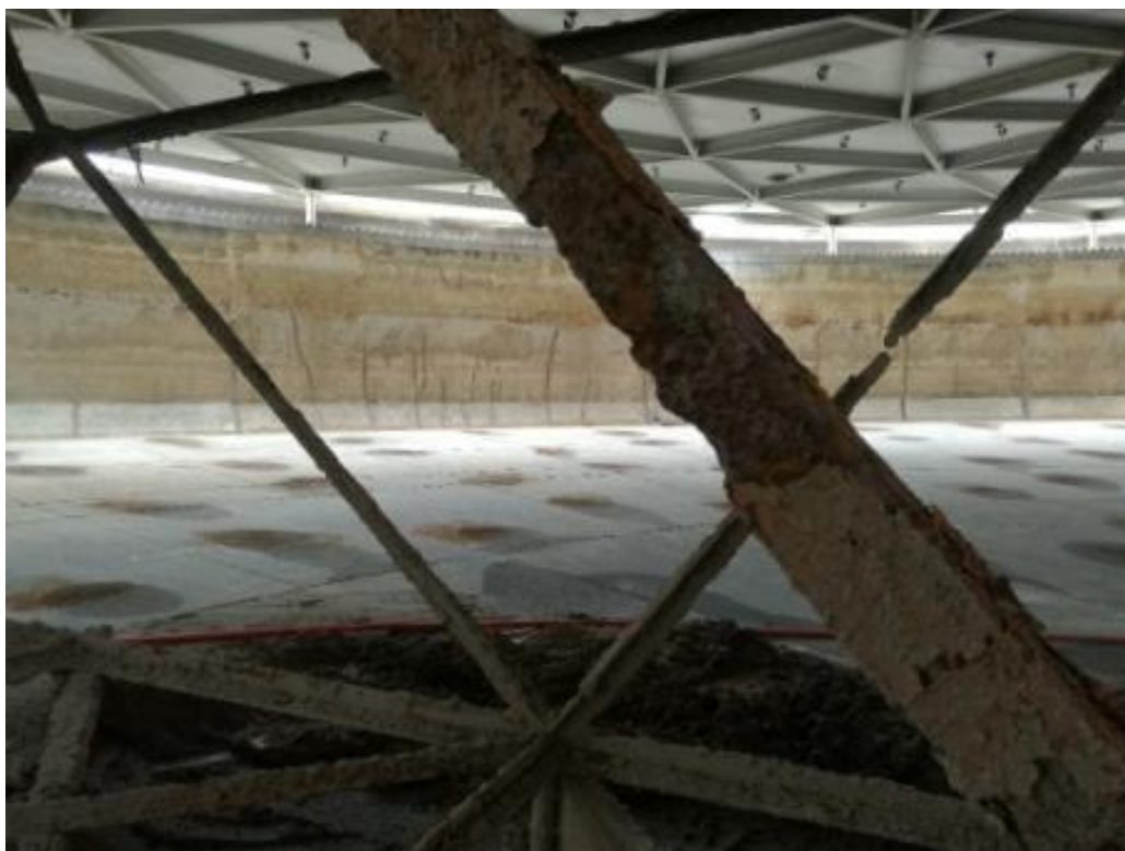
Figura 22. Elementos metálicos afectados por corrosión.
