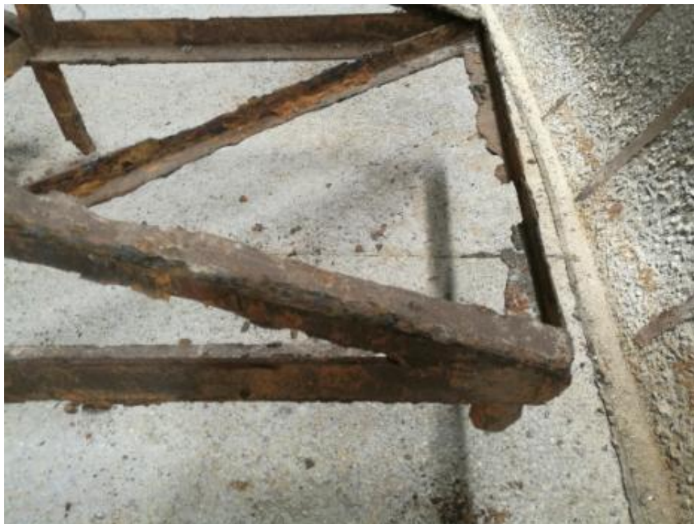
Figura 21. Elementos metálicos afectados por corrosión.
