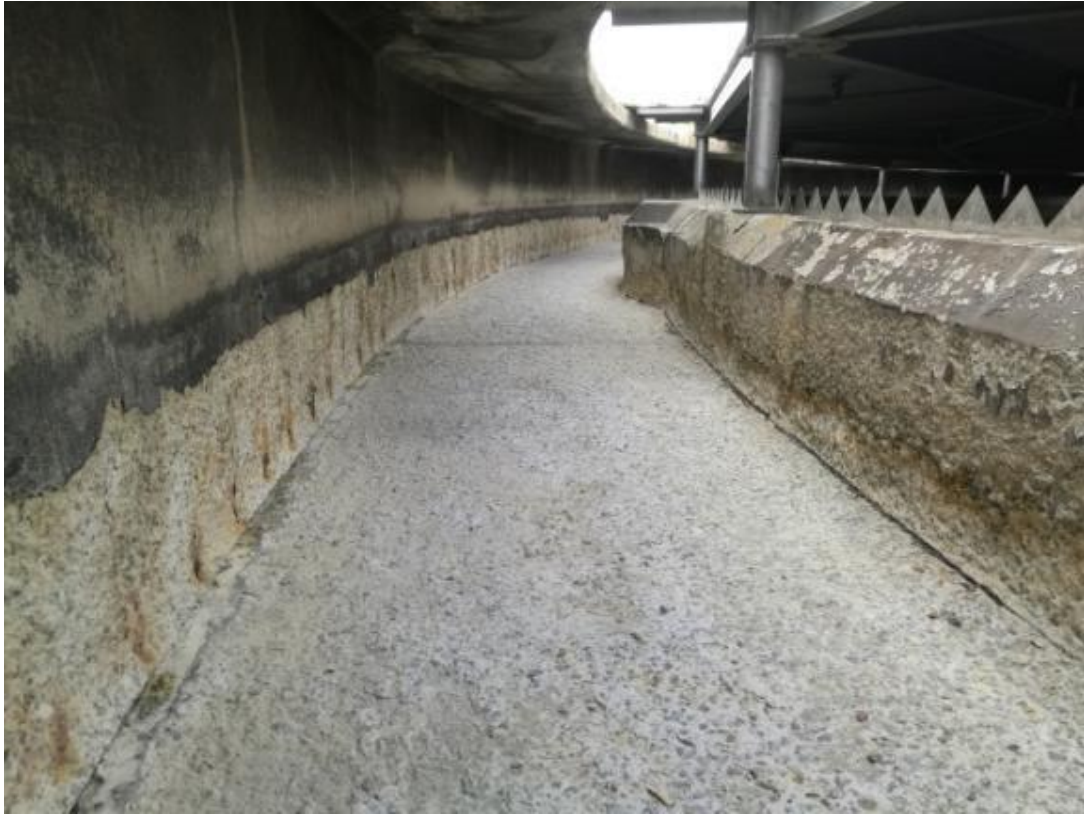
Figura 26. Franja perimetral con pérdida total del revestimiento
