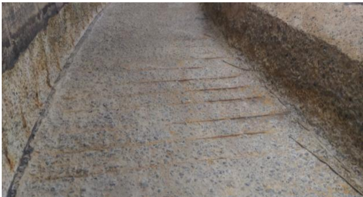
Figura 28. Pérdida recubrimiento en muros y losa del canal de agua clarificada
