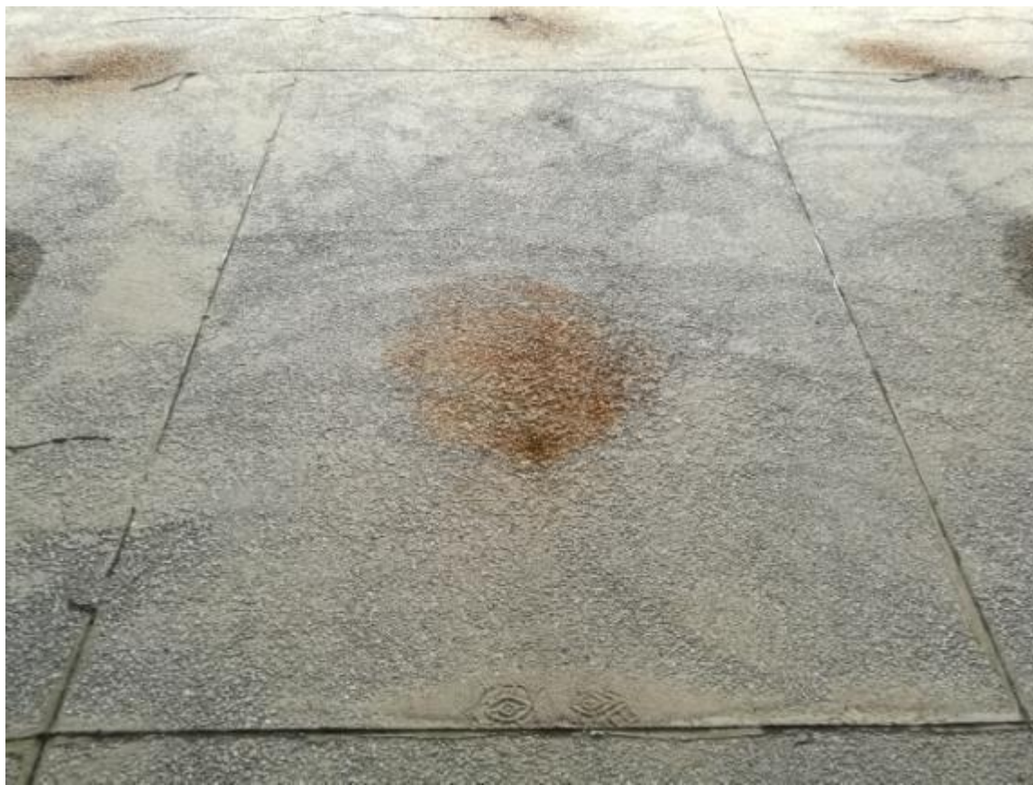
Figura 4. Abrasión leve en losa.
