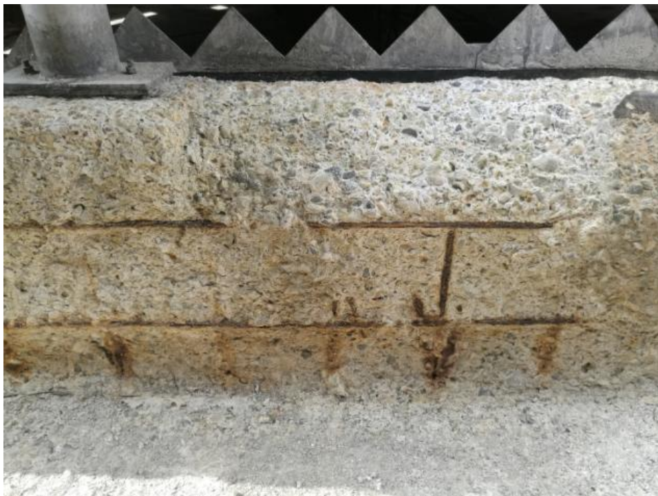
Figura 27. Exposición y corrosión del acero de refuerzo
