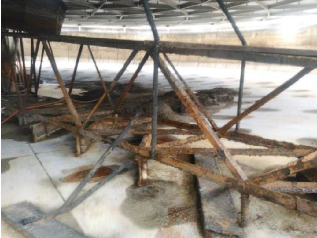
Figura 19. Estado de corrosión del barrelos
