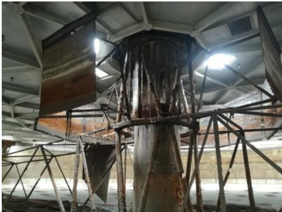
Figura 20. Estado de corrosión del barrelos
