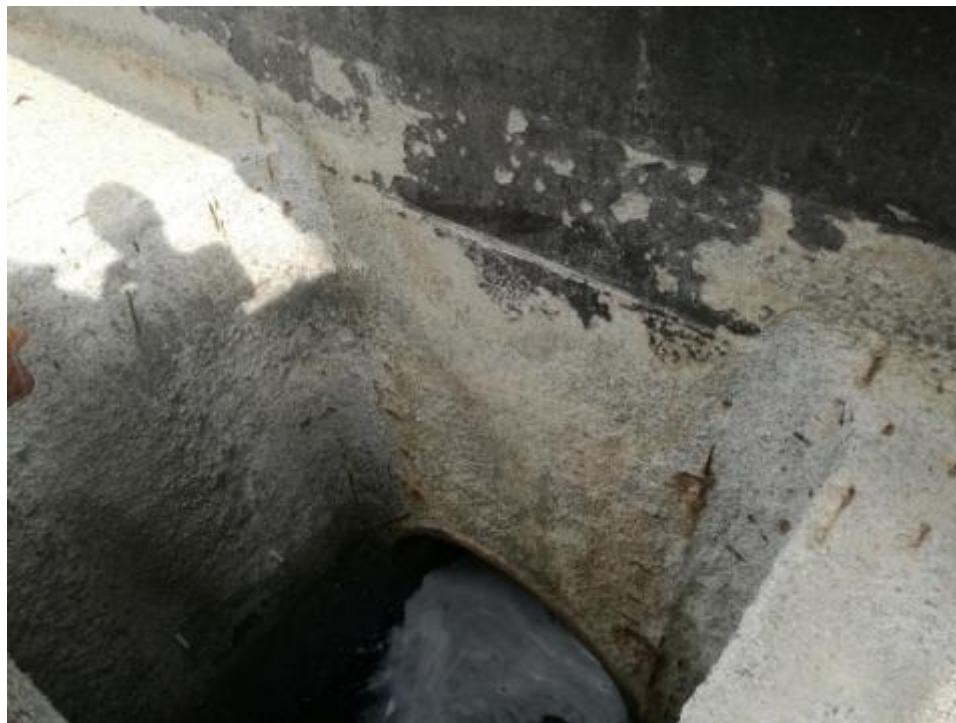
Figura 24. Revestimiento de protección en el canal perimetral gravemente afectado.
