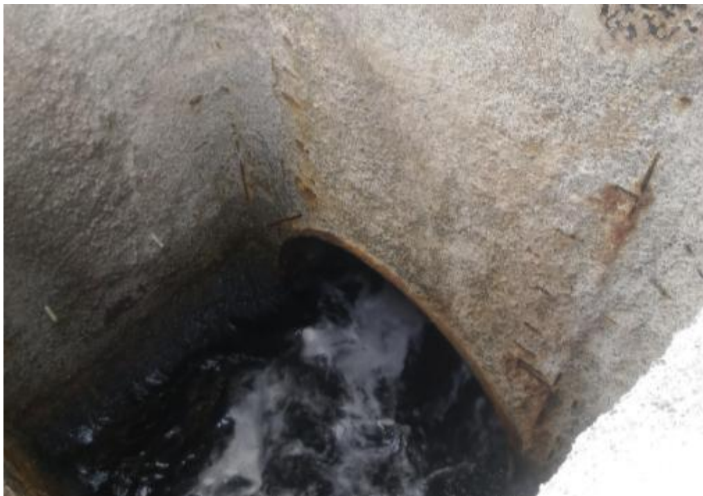
Figura 35. Acero expuesto en la cámara del efluente
