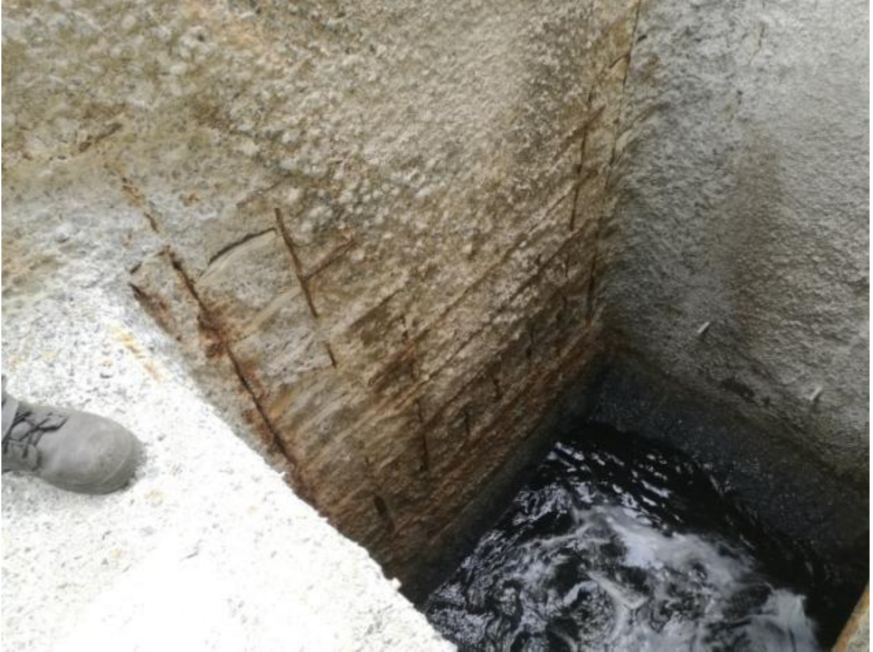
Figura 36. Armadura de refuerzo visible sobre el muro de la cámara del efluente
