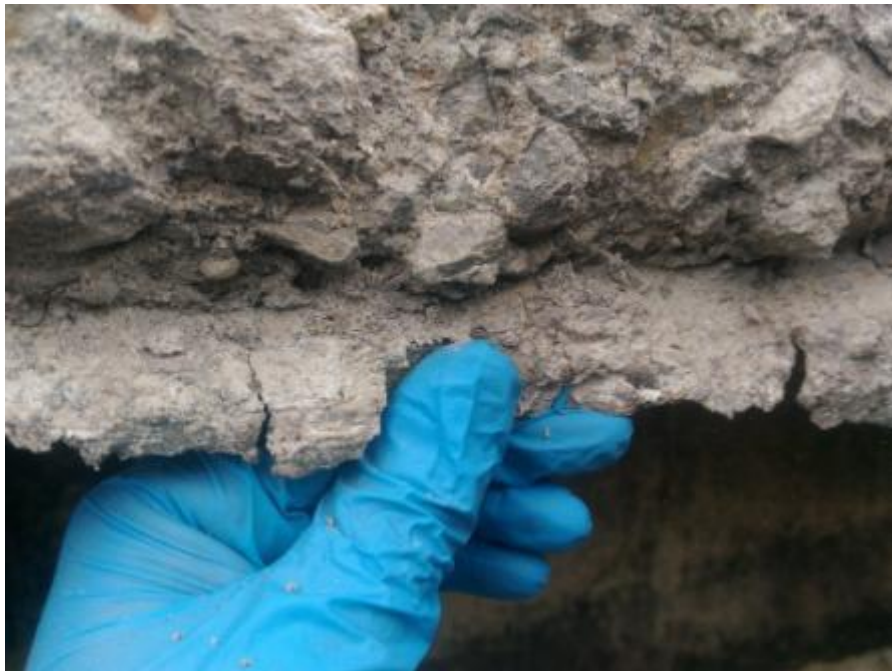
Figura 33. Pérdida de sección en el borde de la losa sobre el canal perimetral
