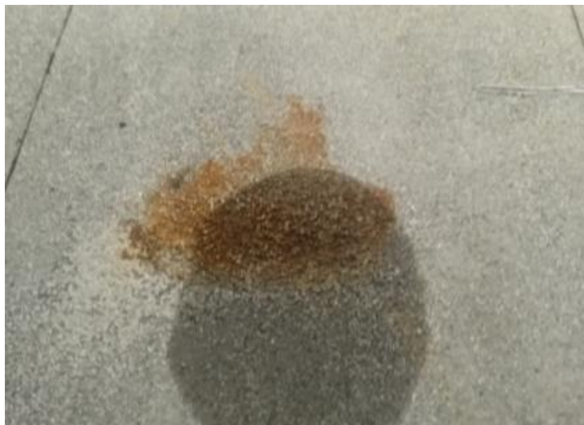
Figura 13. Afectación encontrada en sobre-losa. Mancha cobriza y agujero central
