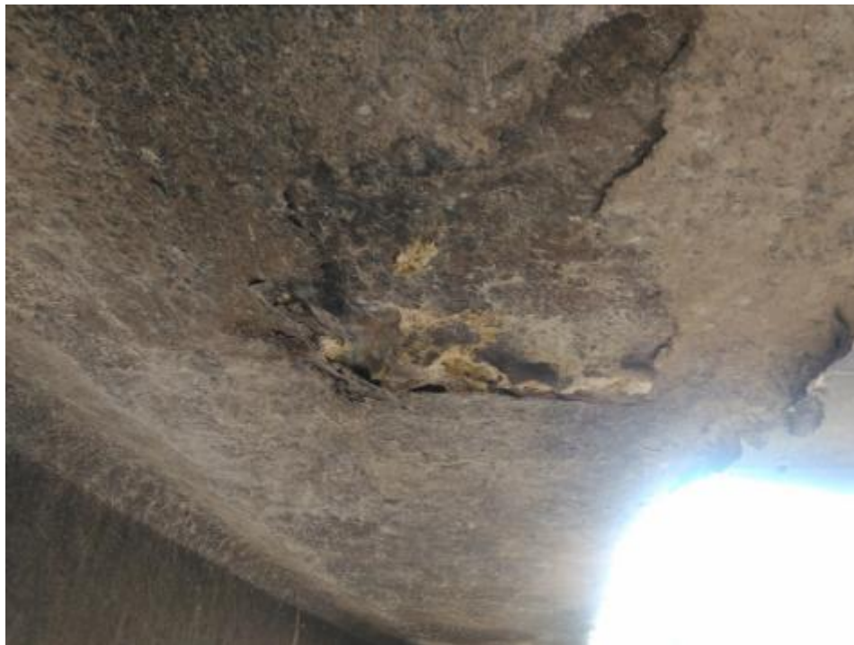
Figura 25. Degradación del revestimiento de protección.
