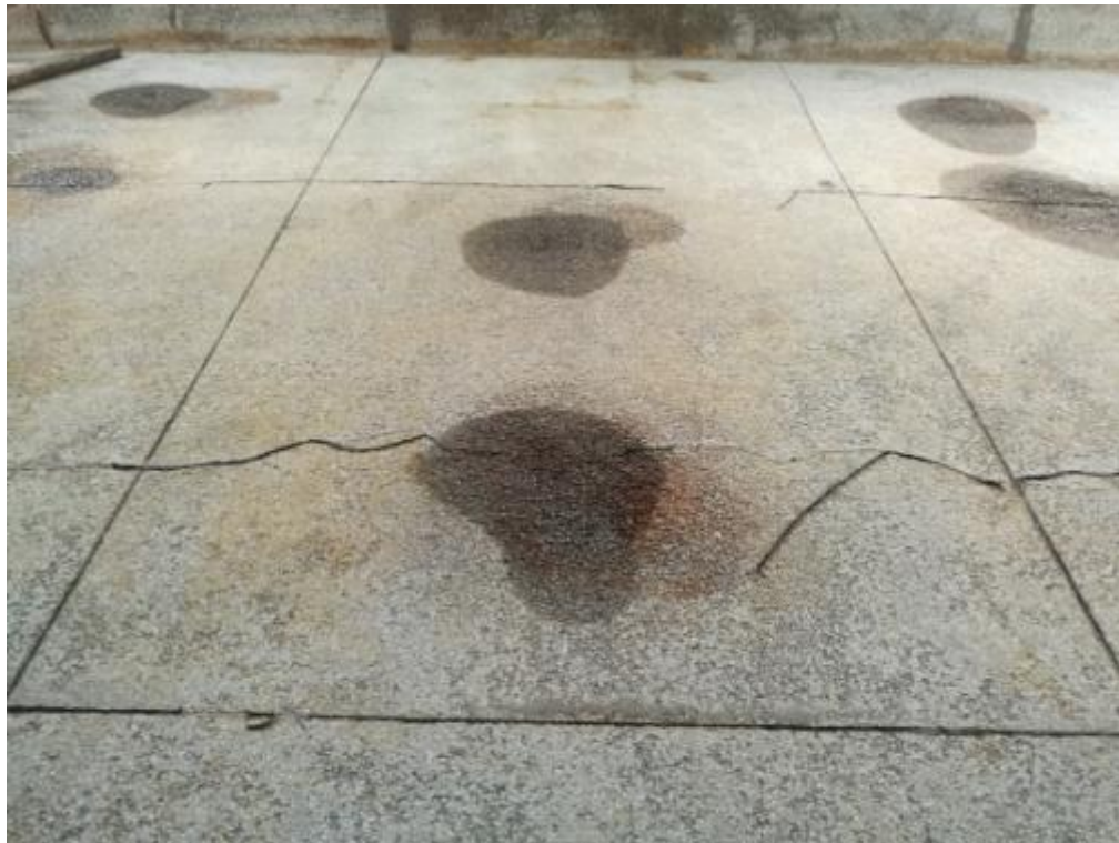
Figura 10. Sello en juntas parcialmente desprendido.
