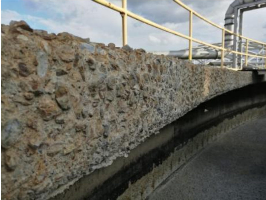
Figura 32. Pérdida de sección en el borde de la losa sobre el canal perimetral.
