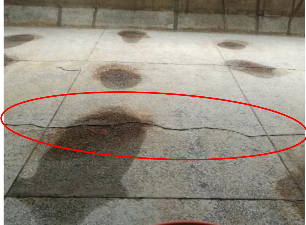
Figura 9. Fisuras típicas en losa de fondo del sedimentador 8.
