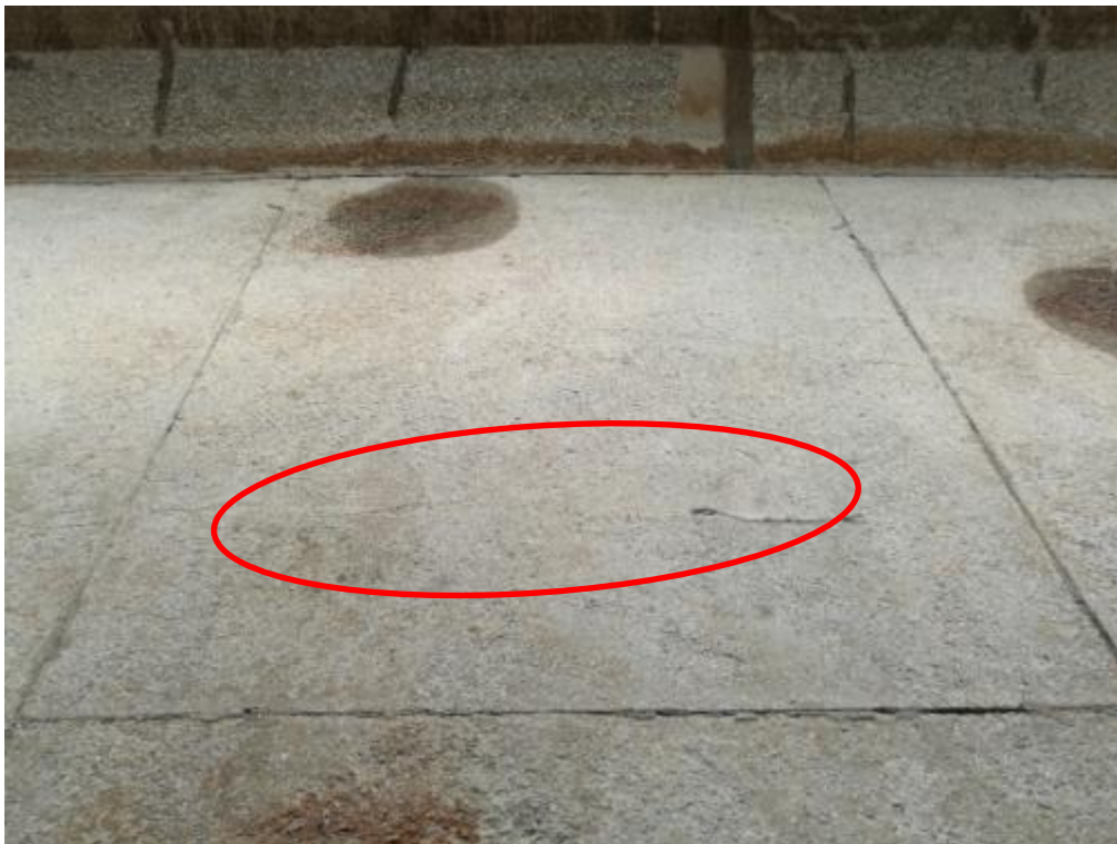
Figura 11. Fisura paralela a junta.
