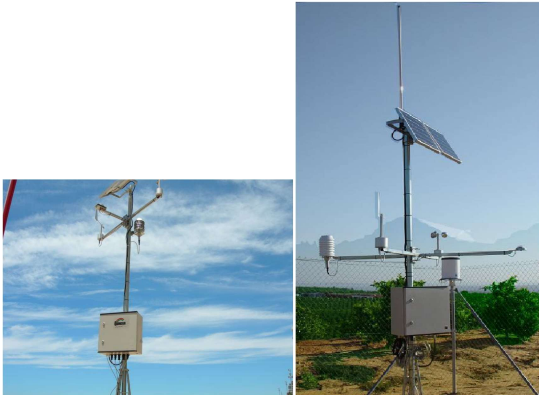
Figura 5. Estación Meteorológica (La estructura definitiva de montaje, será (en función de los sensores))
