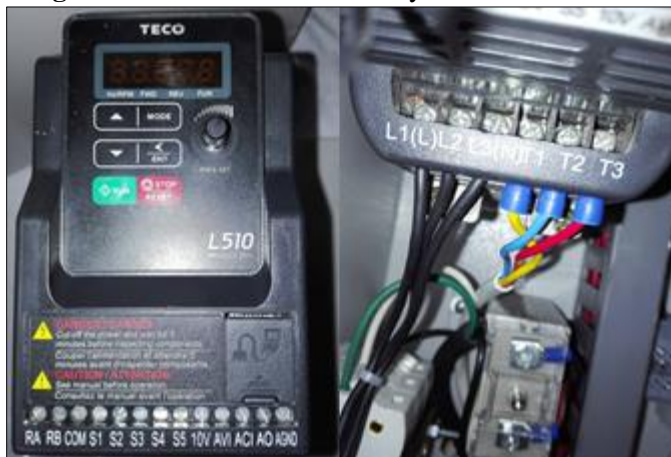
Imagen 3. Variador de frecuencia y conexión.
