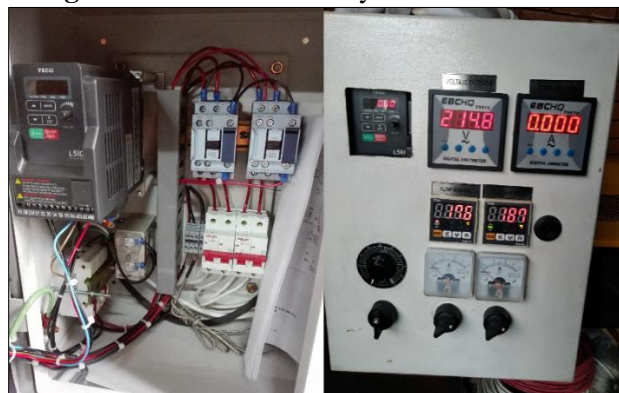
Imagen 6. Tablero eléctrico y de control
