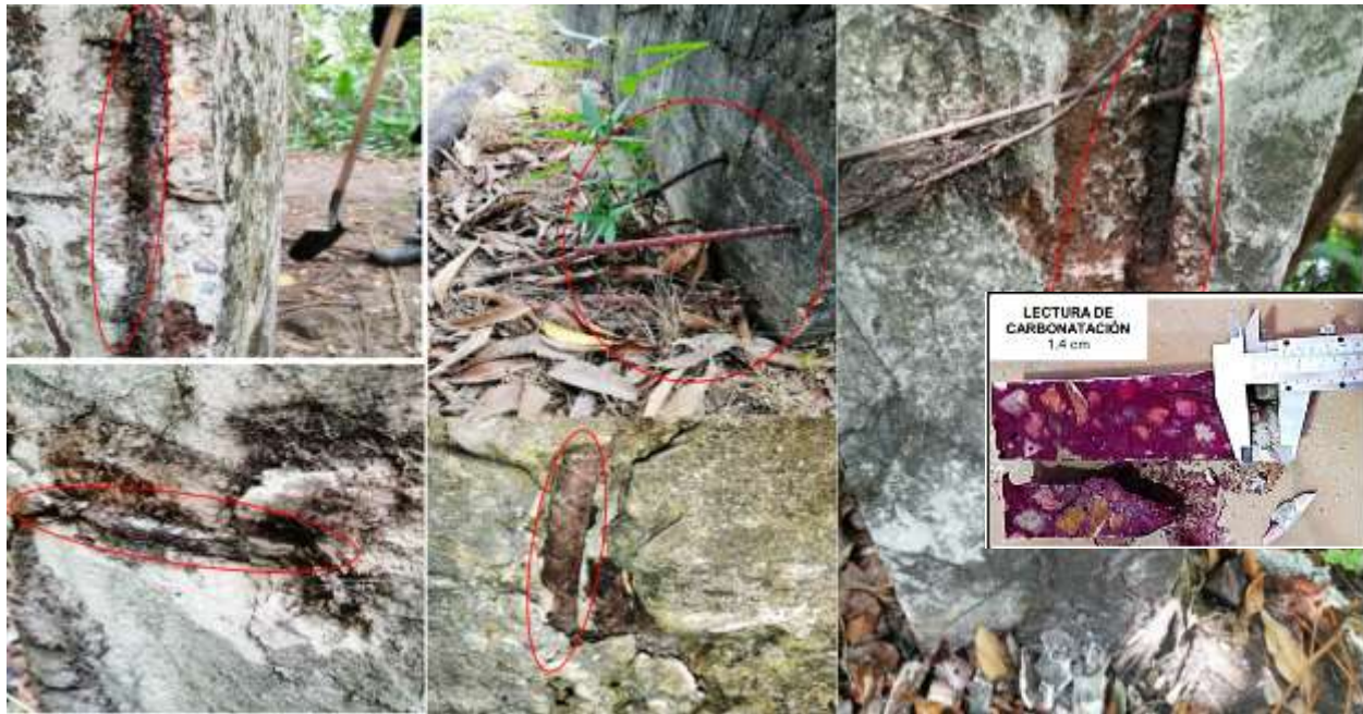
Fotografía 3 Alto nivel de corrosión
