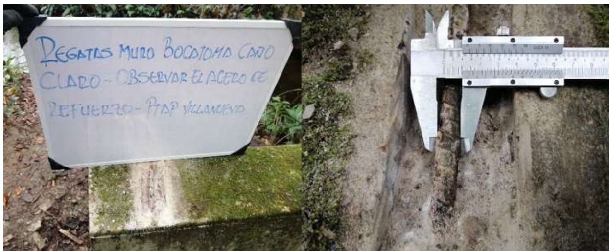
Fotografía 11 Regata en elemento de concreto, bocatoma Caño Claro
