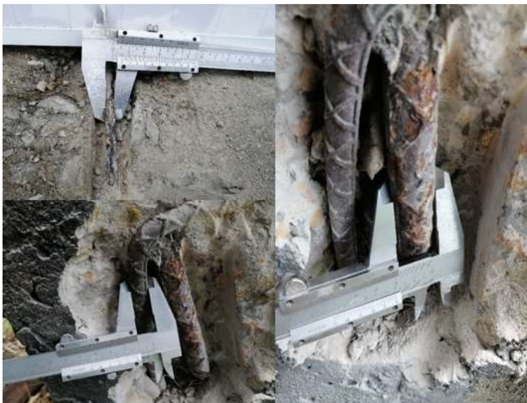
Fotografía 40 Regata en elemento de concreto tanque almacenamiento
