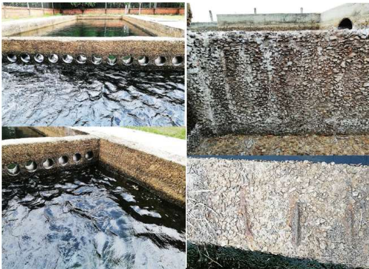
Fotografía 43 Abrasión avanzada en elementos de concreto
