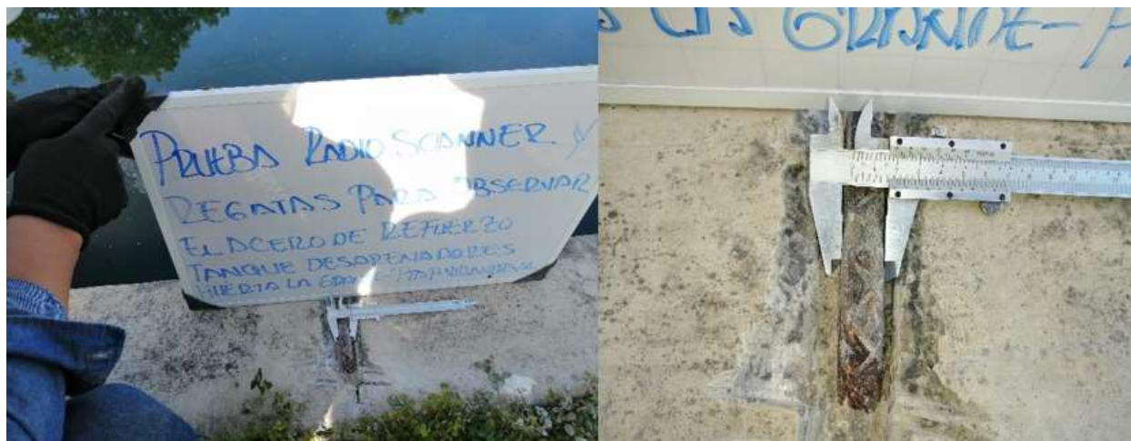
Fotografía 18 Regata en elemento de concreto, desarenador Huerta La grande
