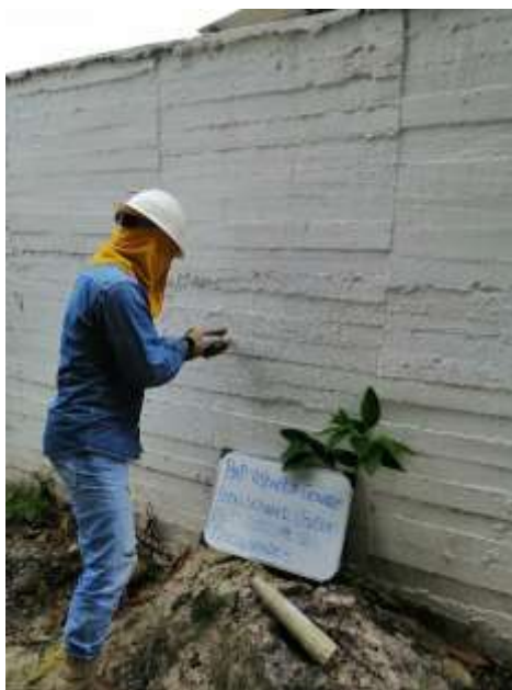
Fotografía 30 Toma de lectura de esclerómetro tanque floculadores
