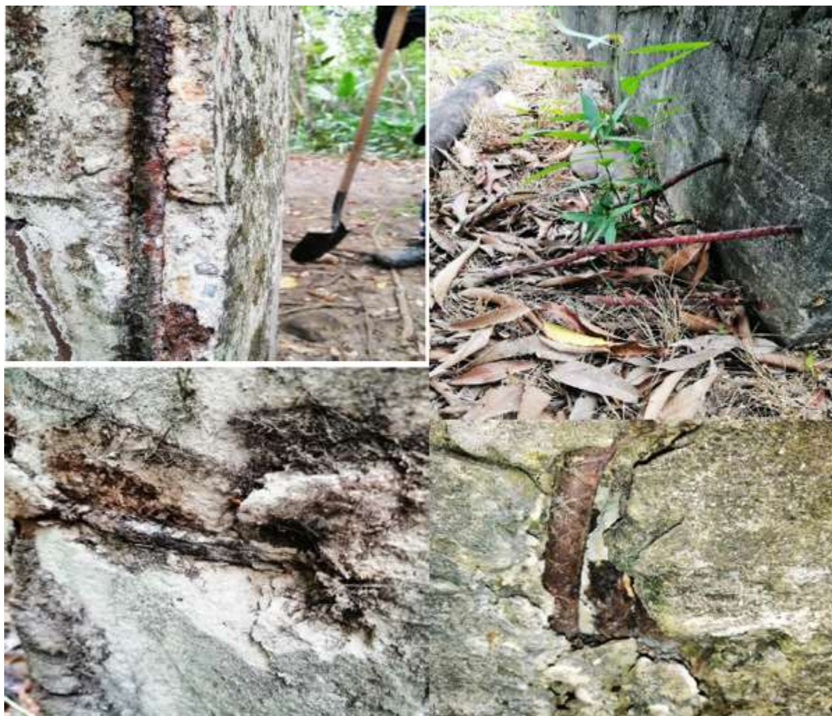
Fotografía 42 Lesiones significativas en elementos de concreto
