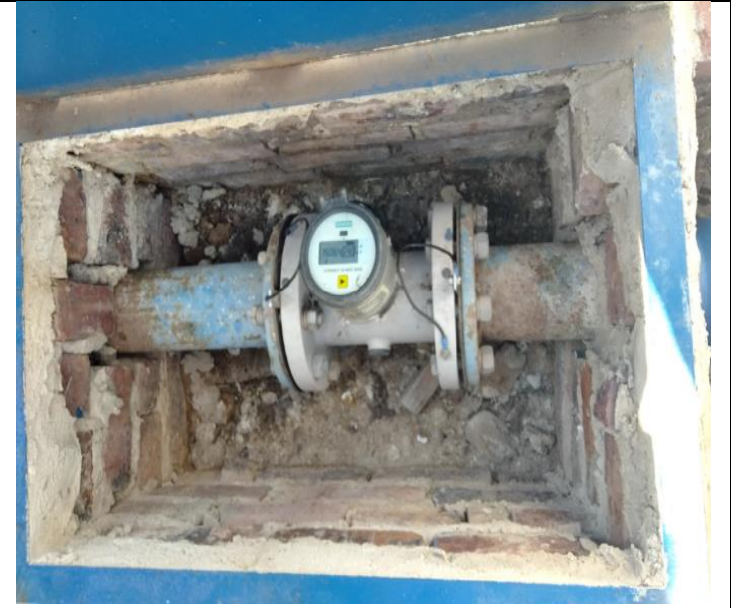
Foto 7. Macromedidor PTAP zona centro.
