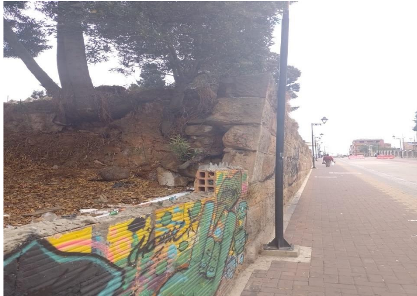
Figura 4 Inclinación Muro San Laureano
