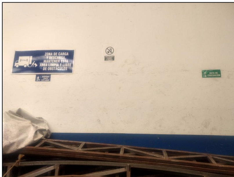
Figura 38 Señalización en la pared de la Ruta de evacuación
