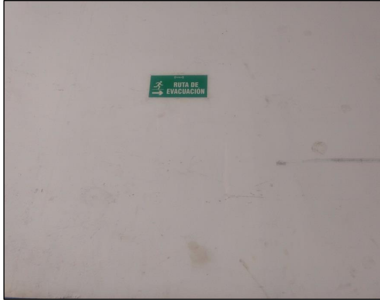
Figura 39 Señalización de la Ruta de evacuación
