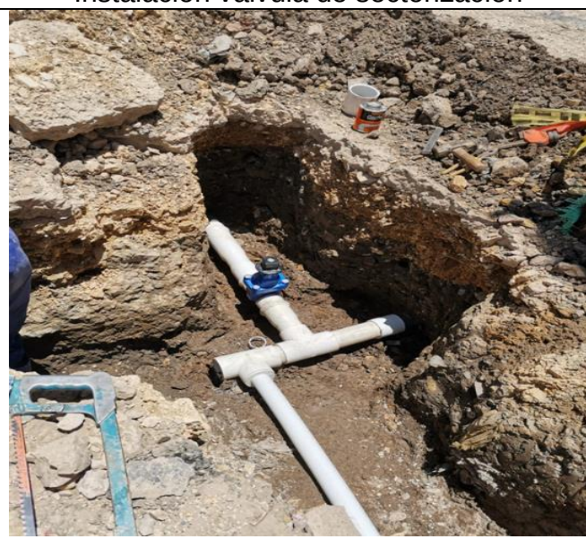
Válvula de sectorización instalada
