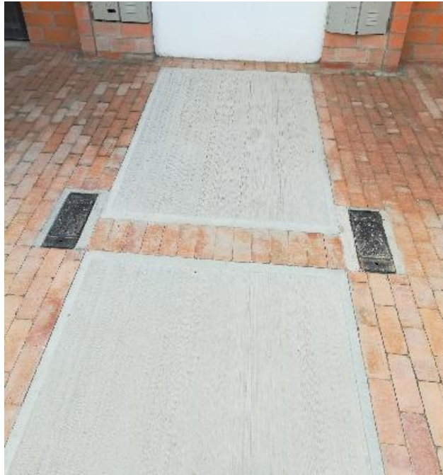
Fotografía 42. Detalle de cajas de inspección mal construido.
