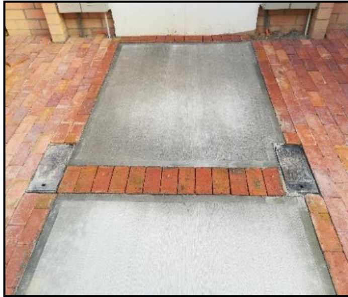
Fotografía 40. Detalle de cajas de inspección mal construido.
