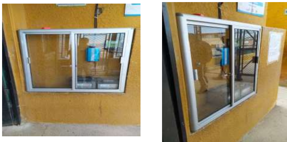
Fotografía 15. Caja donde se instalaron las baterías, el inversor y el controlador Fuente: Autores
