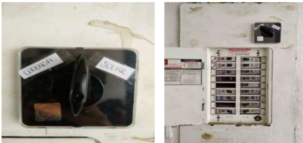
Fotografía 14. Interruptor para dinamizar el fluido eléctrico de la red y del sistema híbrido Fuente: Autores
