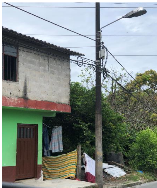
Figura 5-30 Viviendas en riesgo ubicada en la Azotea Fuente: Autores
