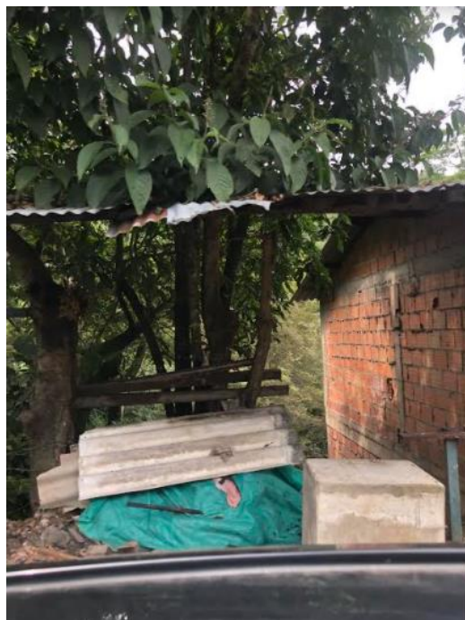
Figura 5-29 Vivienda en riesgo ubicada en la Azotea Fuente: Autores
