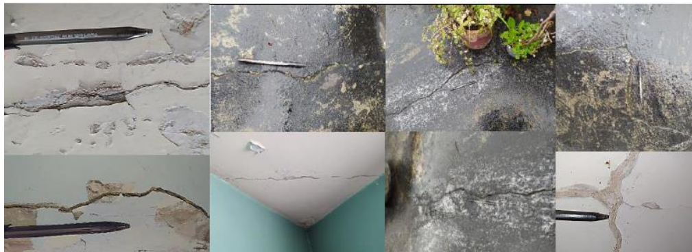
Ilustración 4. Registro fotográfico fisuras y grietas. Fuente propia
