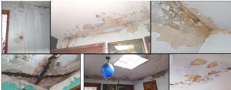
Ilustración 6. Registro fotográfico humedad - filtración. Fuente propia
