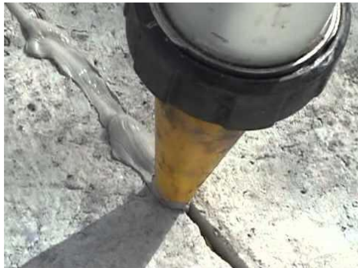
Ilustración 35. Relleno de fisuras y grietas.
