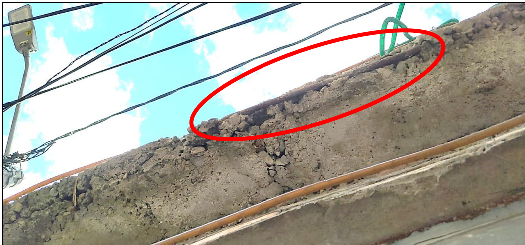
Ilustración 23. Acero de refuerzo de la losa de cubierta a la vista y corroído. Fuente propia
