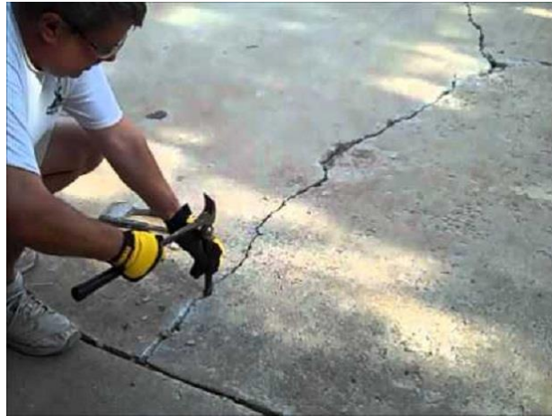
Ilustración 34. Aumento del espesor de fisuras.
