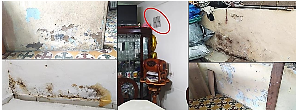
Ilustración 8. Registro Fotográfico Humedad - capilaridad. Fuente propia
