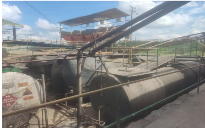
Figura 10.3 Tanques de asfalto empresa ECOBRAS S.A
