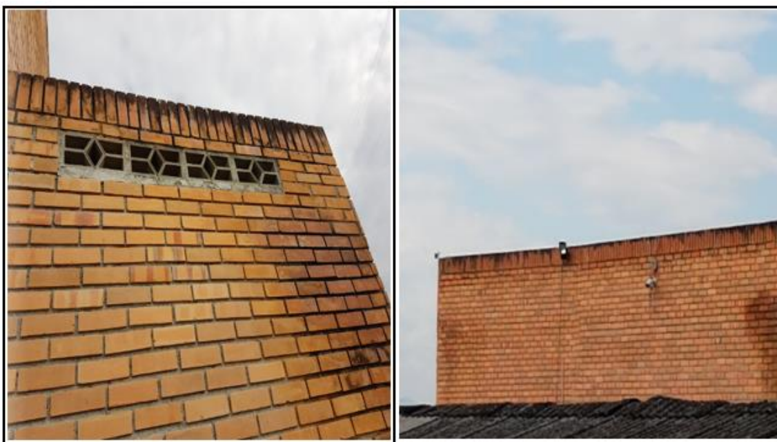
Gráfica 15: Síntoma, moho en la fachada causado por la humedad. Fuente: Los autores.
