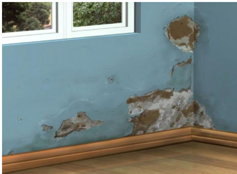
Gráfica 1: Ejemplo de humedad en una construcción: Fuente: (Andes, 2012)
