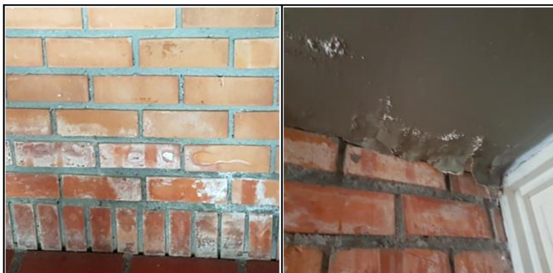
Gráfica 14: Síntoma, eflorescencia en los muros de ladrillo. Fuente: Los autores.
