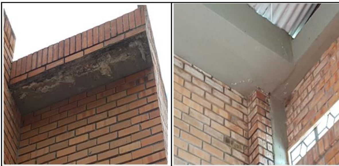
Gráfica 11: Síntoma, filtración de la humedad por tensión superficial. Fuente: Los autores.
