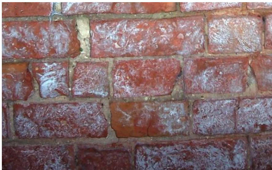
Gráfica 2: Ejemplo de eflorescencia. Fuente: (Albañilería, 2016).
