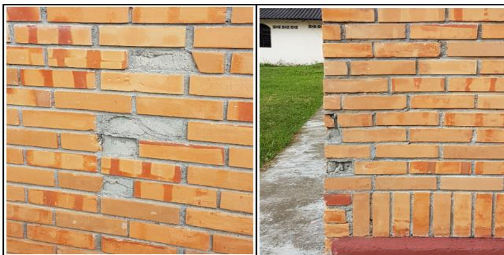
Gráfica 12: Síntoma, Desprendimientos en la fachada. Fuente: Los autores.
