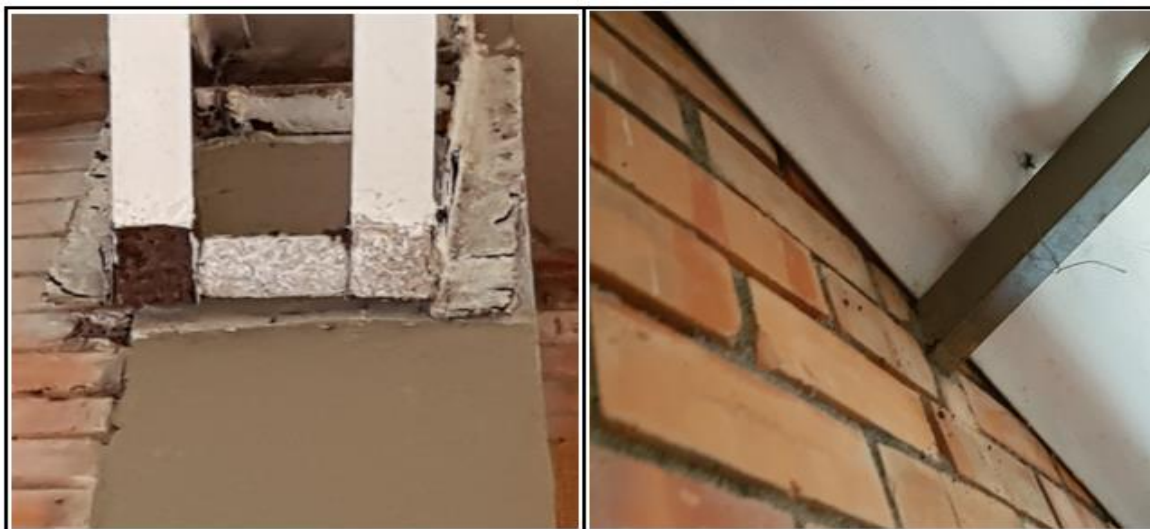
Gráfica 13: Síntoma, corrosión en los elementos metálicos. Fuente: Los autores.
