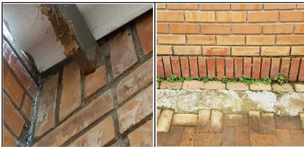
Gráfica 10: Síntoma, presencia de materia orgánica creciendo en la edificación. Fuente: Los autores.
