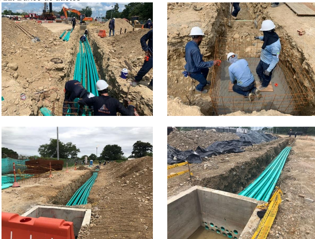
Figura 12. Banco de ductos
