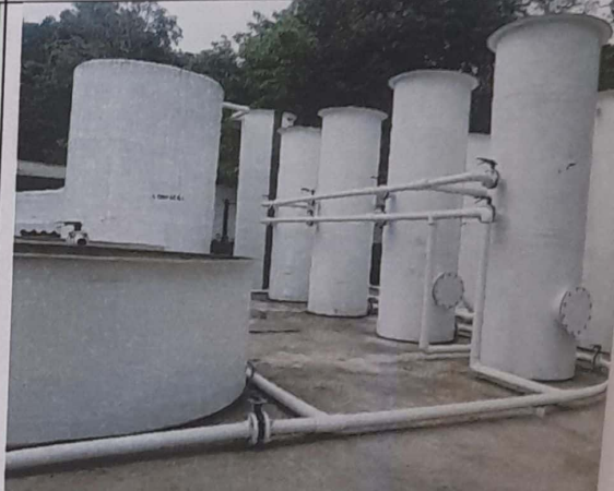
Planta de tratamiento diseñada para operar los procesos unitarios convencionales de potabilización
