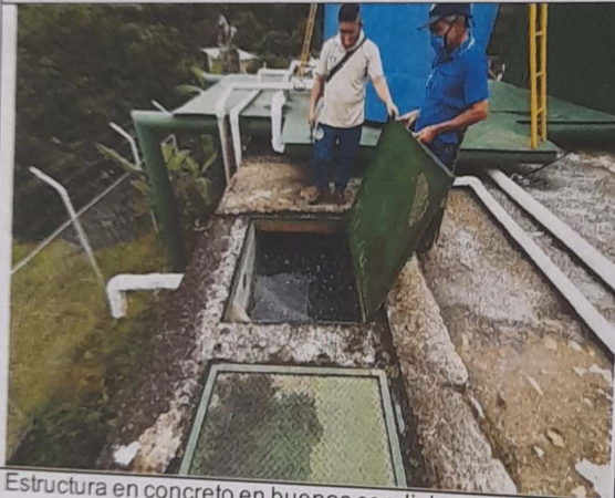
TANQUE DE ALMACENAMIENTO PTAP SAN MARCOS
