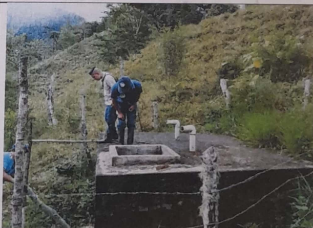
Tanque requiere limpieza y mantenimiento
