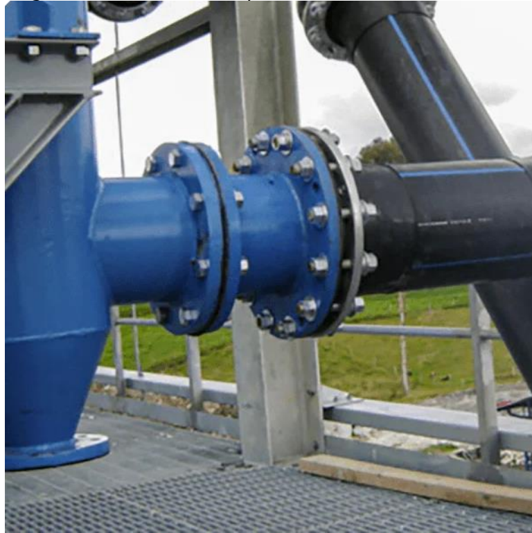
Figura 13. Tubería dirigida a la industria transformadora.
