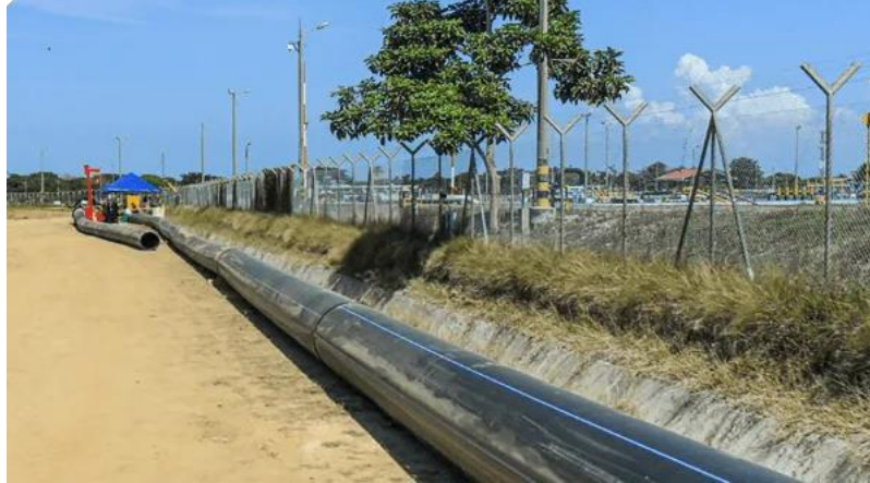
Figura 9. Tubería dirigida al sector de hidrocarburos.
