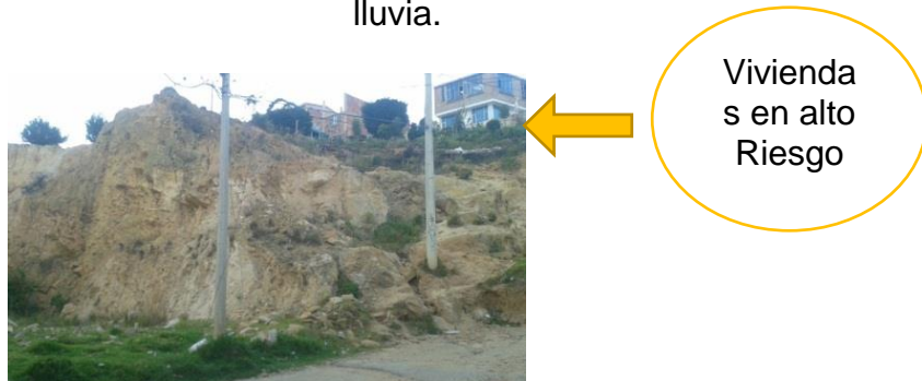
Fotografía 5. Se evidencia perdida de material en masa debido a erosión por lluvia.
