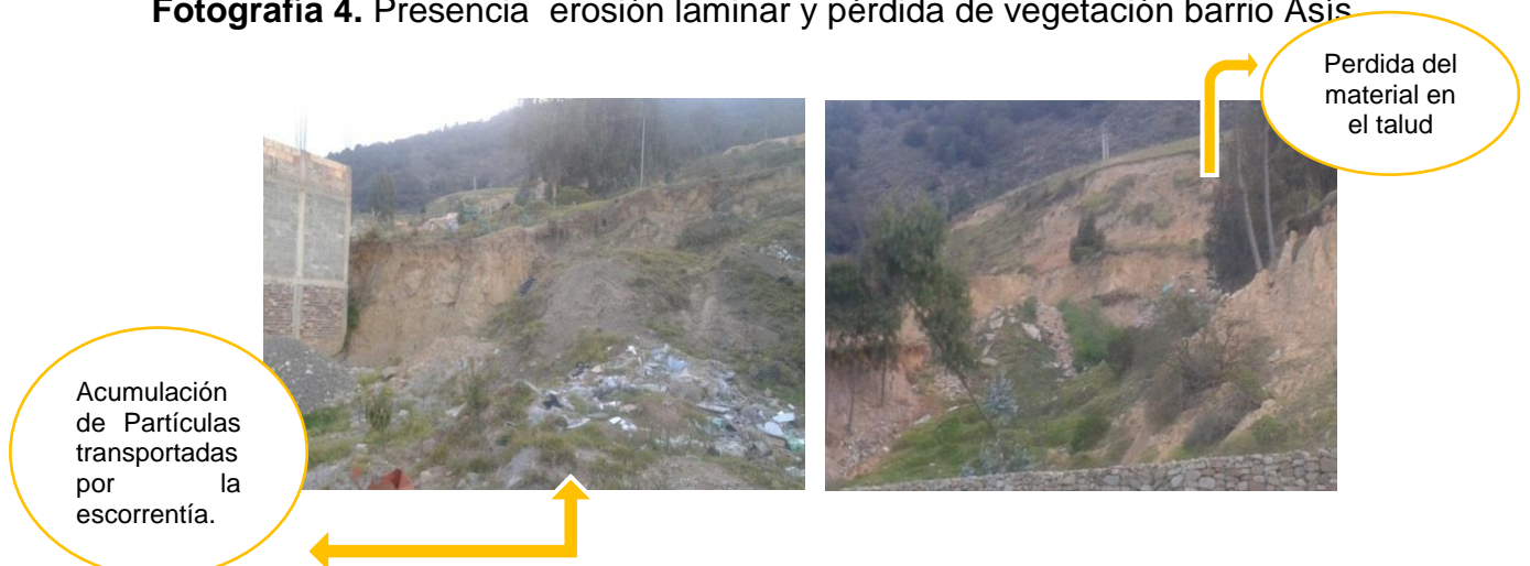
Fotografía 4. Presencia erosión laminar y pérdida de vegetación barrió Asís
