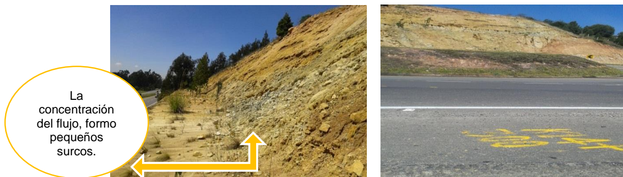
Fotografía 6. Presencia de surcos en la doble calzada Bogotá- Sogamoso ubicada k 14+300
