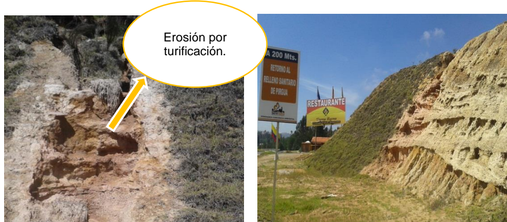
Fotografía 11. Proceso erosivo por tubificación vía Bogotá Sogamoso a 200metros del relleno sanitario
