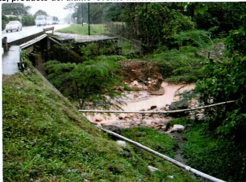
Figura 7.6 Cauce del Caño Pendejo, donde se puede apreciar material acumulado en sus orillas, producto del último evento fluviotorrencial.
