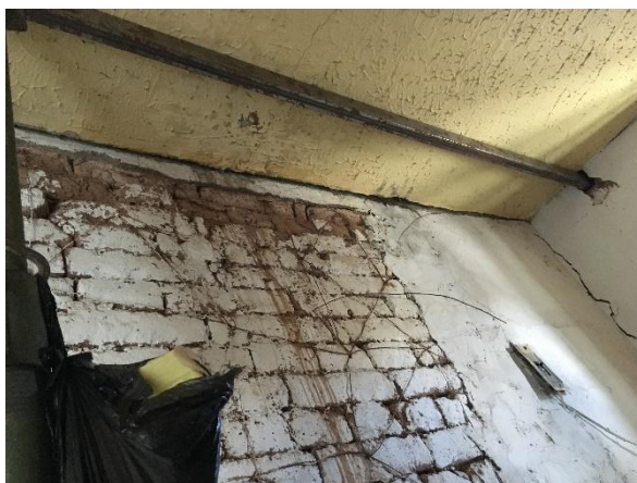
Figura 54 Deterioro de Viviendas Aledañas
