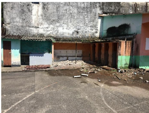
Figura 27 Baños Existentes Deteriorados
