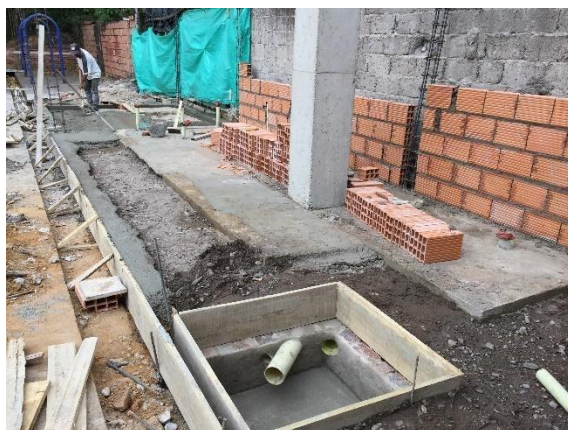
Figura 40 Caja de Inspección
