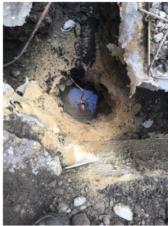
Figura 56 Instalación Polo a Tierra
