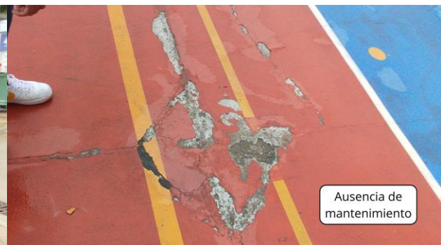
Figura 22. Deterioro en canchas
