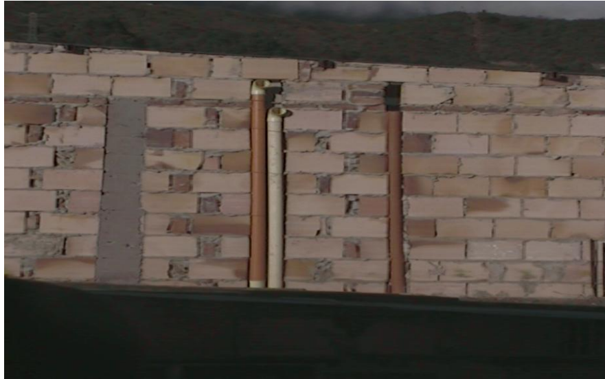
Debilitamiento de los muros por instalaciones sanitarias y combinación de materiales.
