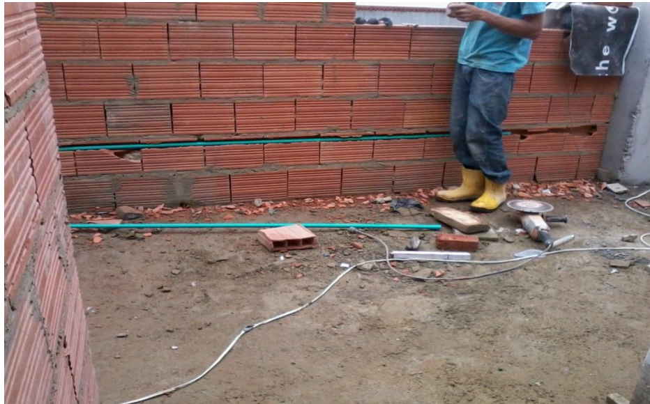
Debilitamiento de la mampostería por regatas para instalaciones electricas e hidraulicas, Etc.
