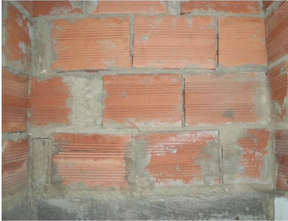
Muros sin ningún tipo de confinamiento.
