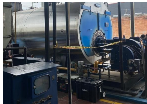
Figura 7. Caldera 3. Fuente: Autor
