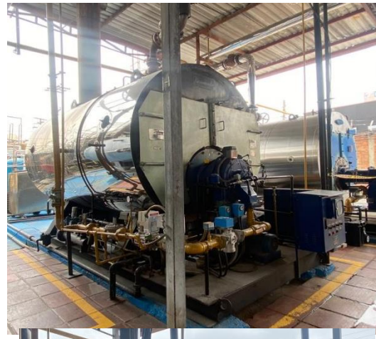
Figura 6. Caldera 2. Fuente: Autor
