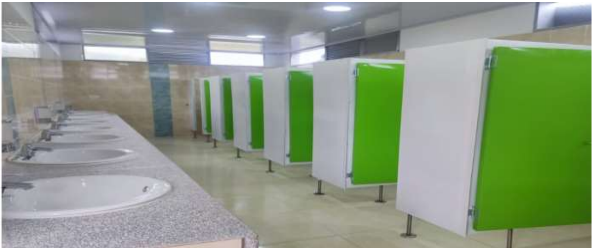
Figura 10 Nueva batería sanitaria escuela urbana.
