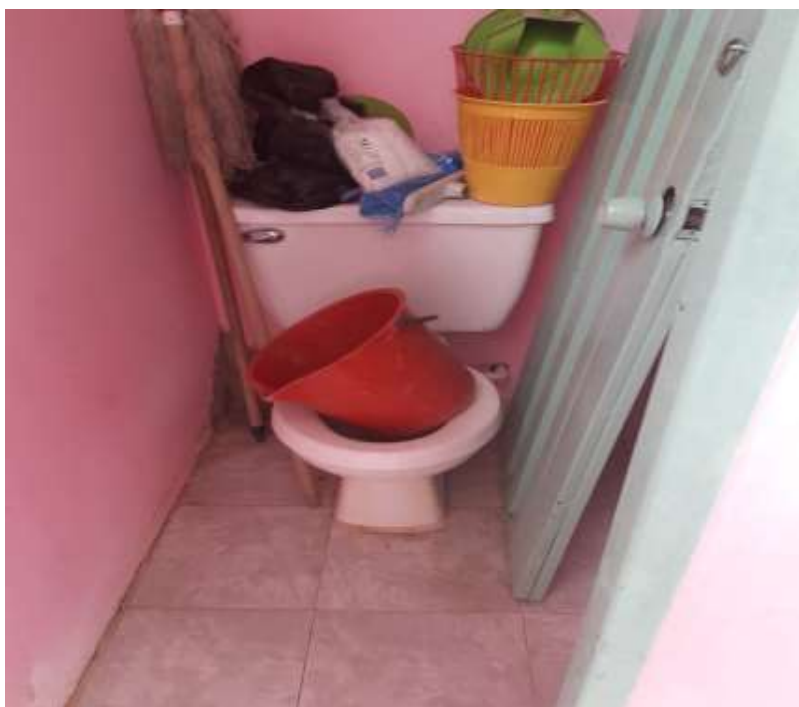
Figura 17 Condiciones iniciales escuela agua blanca
