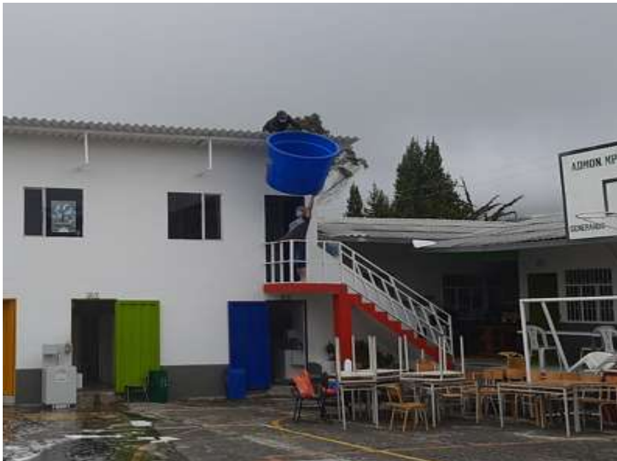
Figura 16 Instalación Tanque de reserva colegio de el cardón
