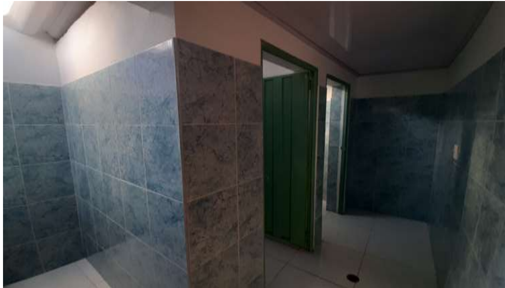
Figura 14 Nueva batería sanitaria escuela loma alta
