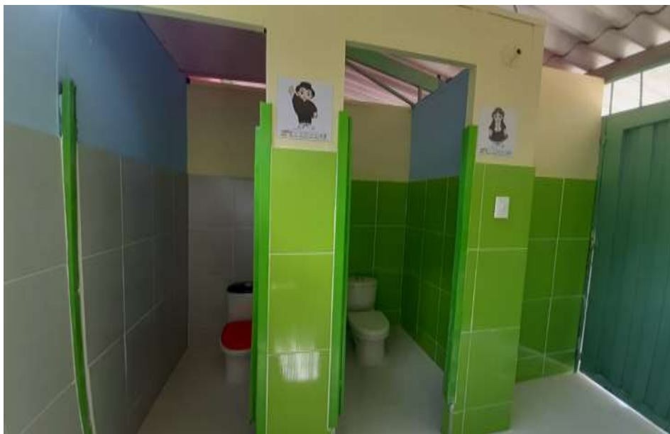
Figura 18 Batería sanitaria escuela agua blanca
