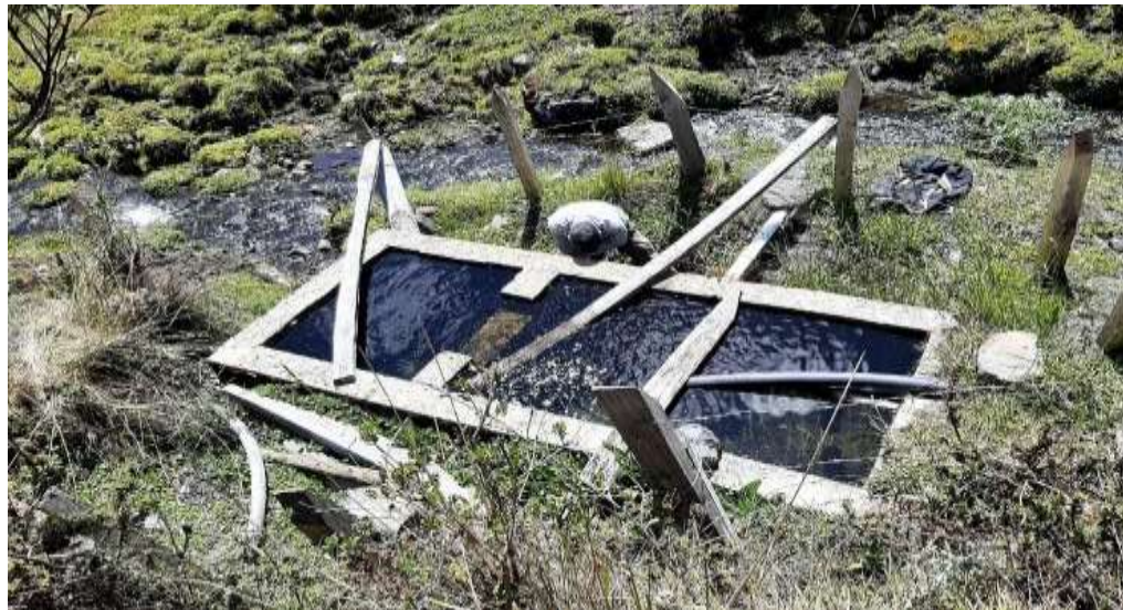
Figura 3 Tanque acueducto el mortíño
