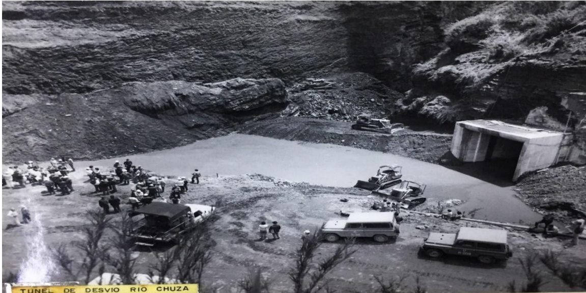
Figura 13. Túnel que desvía el río Chuza al embalse. Inicios de la obra en el páramo.
