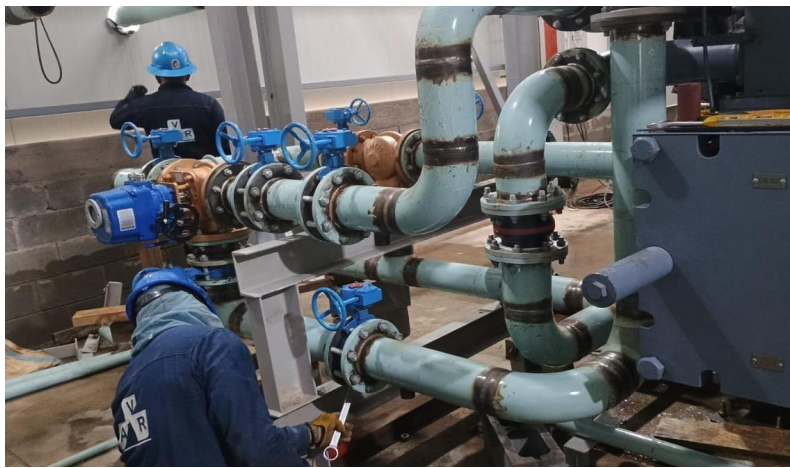
Figura 9. Conexiones de tuberías.
