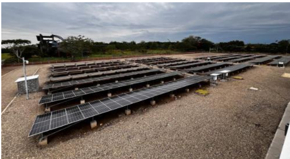
Figura 26. Módulos de paneles solares finalizados.
