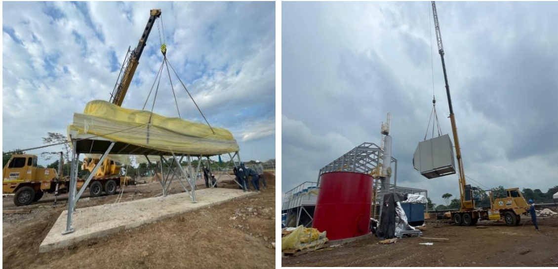
Figura 8. Montaje y ubicación de ventiladores y radiador.
