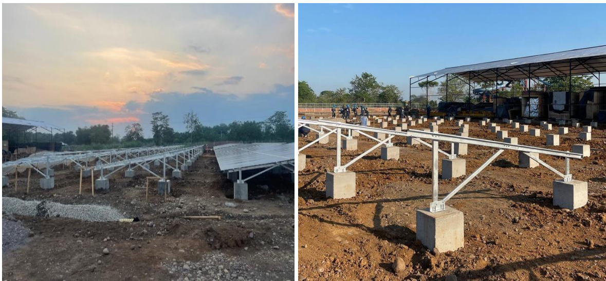
Figura 6. Estructura metálica de paneles solares.
