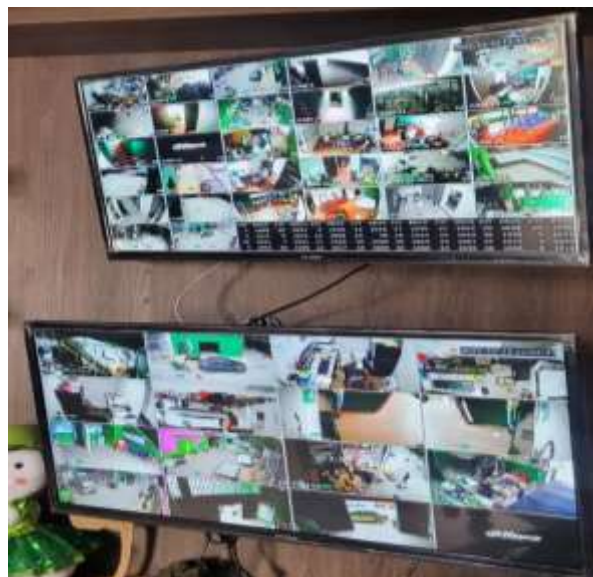
Ilustración 10. Sistema de seguridad de cámaras
