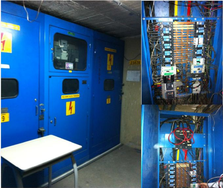
Figura 16. Imágenes de la segunda subestación, edificio de Biblioteca. Fuente del autor.
