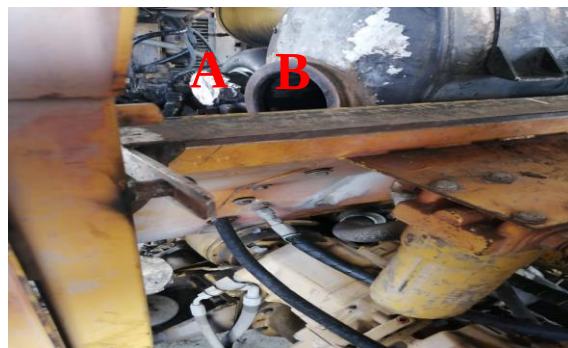
Figura 22 Salida del turbocompresor (A) – Entrada a la caja de humo (B)
