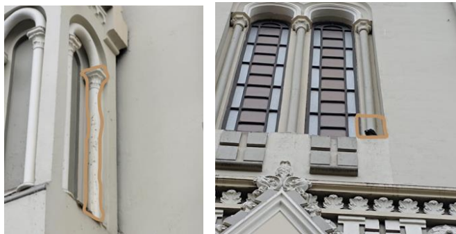
Figura 13 Lesión química - presencia organismos animales en fachada lateral
