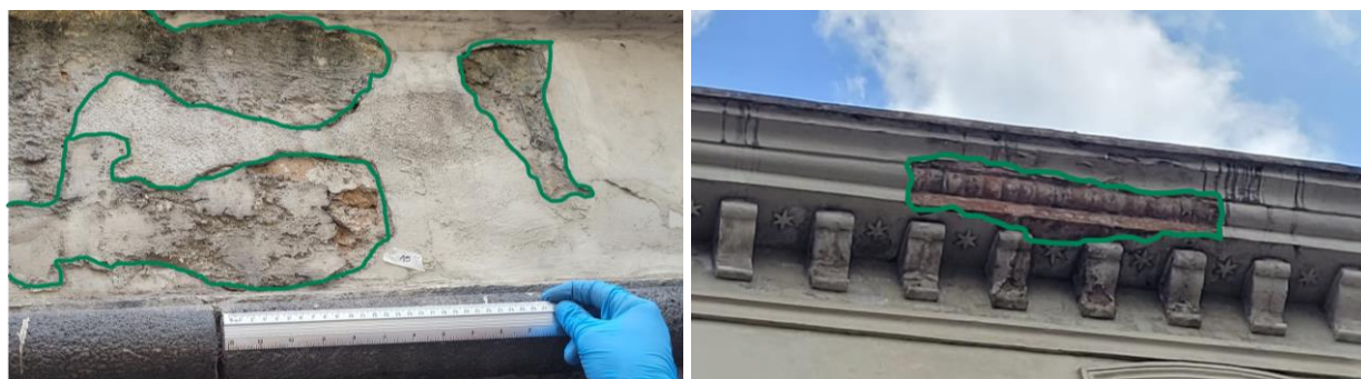
Figura 9 Lesión Mecánica - Desprendimiento en acabados continuo exterior de fachada lateral
