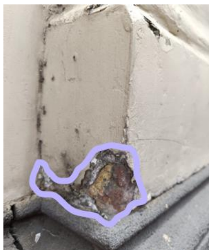
Figura 10 Lesión Mecánica - erosión en lateral fachada Carrera 24 entre Calle 20 y 21
