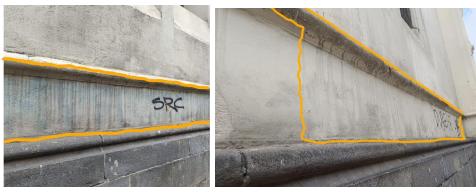
Figura 8 Lesión física – suciedad por lavado diferencial exterior de fachada lateral.
