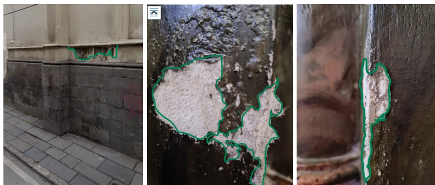
Figura 11 Lesión química - presencia de eflorescencia en parte interna lateral derecho Carrera 24. 2024
