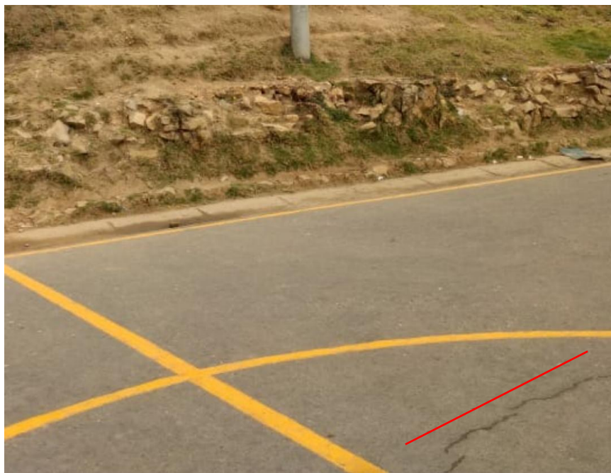
Ilustración 26. Grietas del Escenario Deportivo
