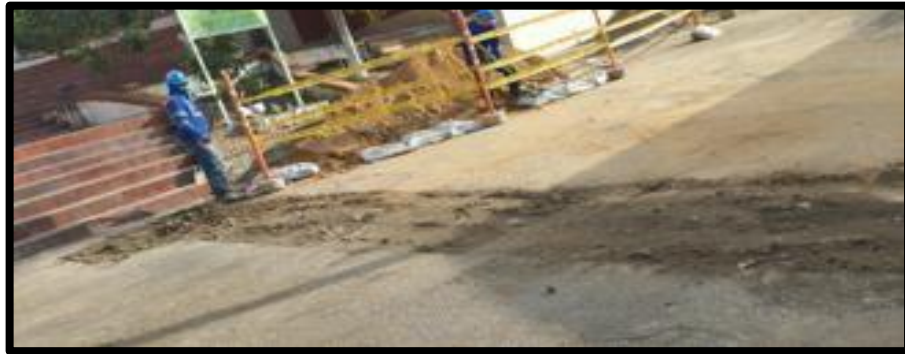
Figura 10. Cruce Av 16 Barrio El Contento.
