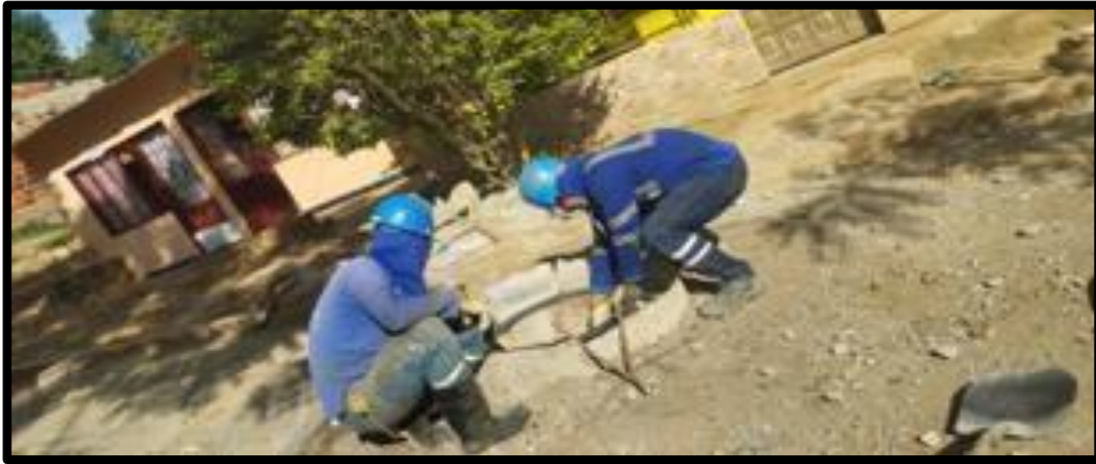
Figura 13. Fundición tapa pozo
