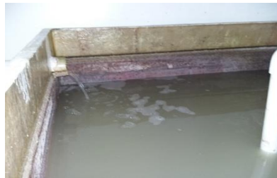
Imagen 7: Tanque homogenización PTAR.
