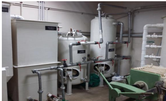
Imagen 10: Filtro de arena y carbón activado.
