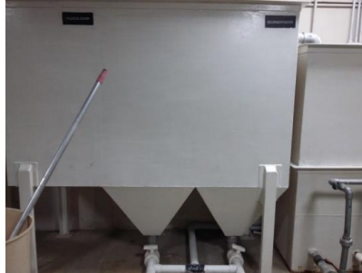
Imagen 9: Tanque floculador y sedimentador.
