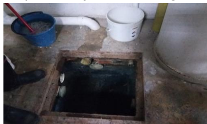
Imagen 11: Caja de inspección y ducto de agua de salida de la PTAR.
